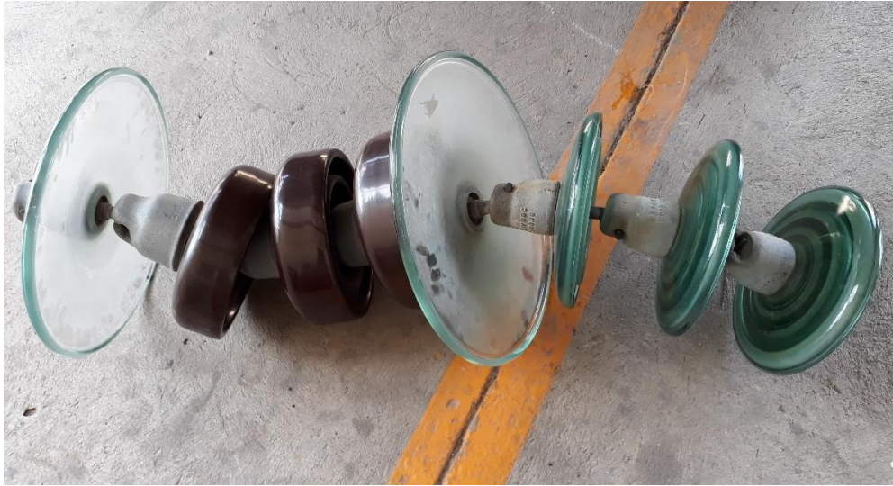
Ilustración 46 Cadena de Aisladores Combinada. Aislamiento Contaminado. Estructura #126.
