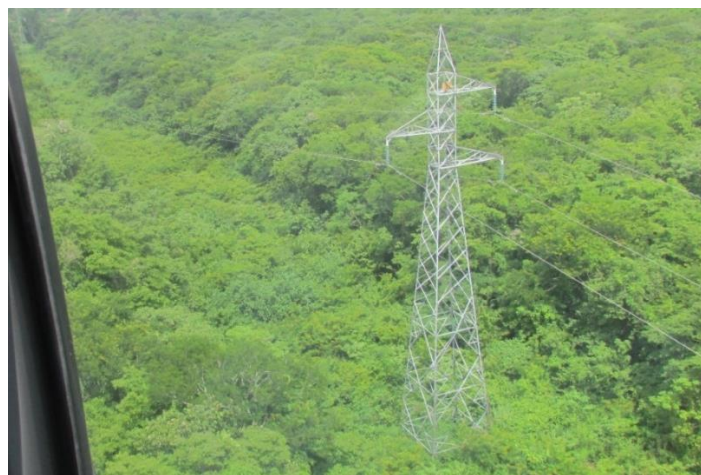
Ilustración 39 Torre Tipo de la Línea de Subtransmisión ANG-73970-TGD.
