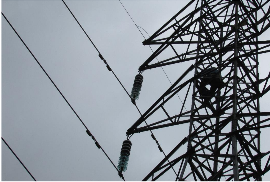
Ilustración 3 Torre Autosoportada de Celosía, 2 Circuitos, 1 Conductor por Fase, 115KV.
