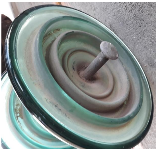
Ilustración 45 Aislador Contaminado. Estructura #126.
