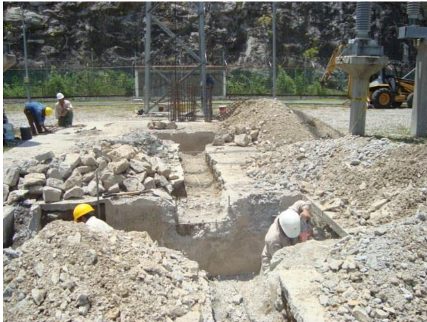
En la imagen se aprecia como se realizan las excavaciones para el lugar que ocupara las trincheras
