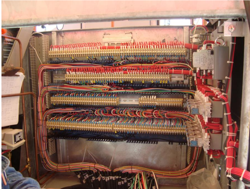
Gabinete ya con las conexiones avanzadas.
