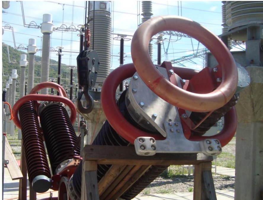
Conectores y aros equipotenciales.
