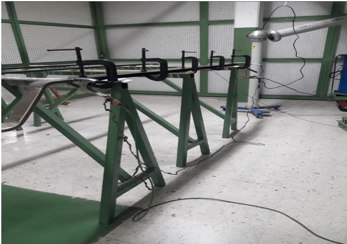
Figura 14. Conexión de dispositivos de medición de factor de potencia a la barra bastón para realizarle la prueba.
