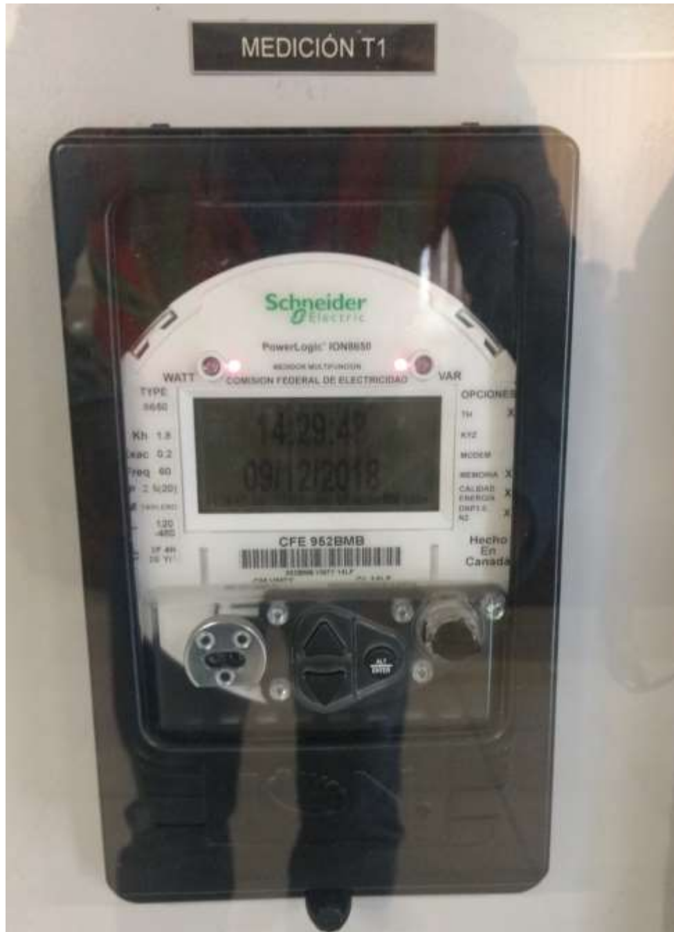
Figura 18 Multimedidores de energía para transformador T1 (Marca ION)
