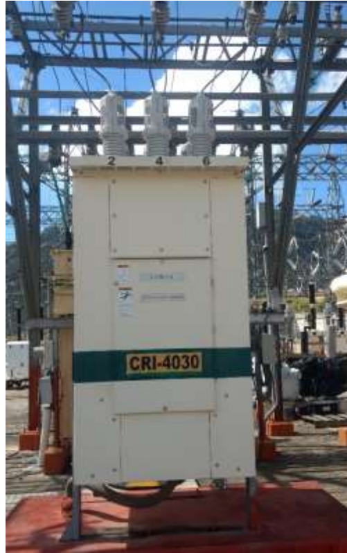
Figura 21 Interruptor de potencia en vacío CRI-4030
