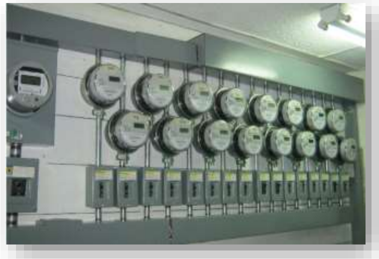
Figura 12 Ejemplo de una concentración de medidores con tecnología AMI.
