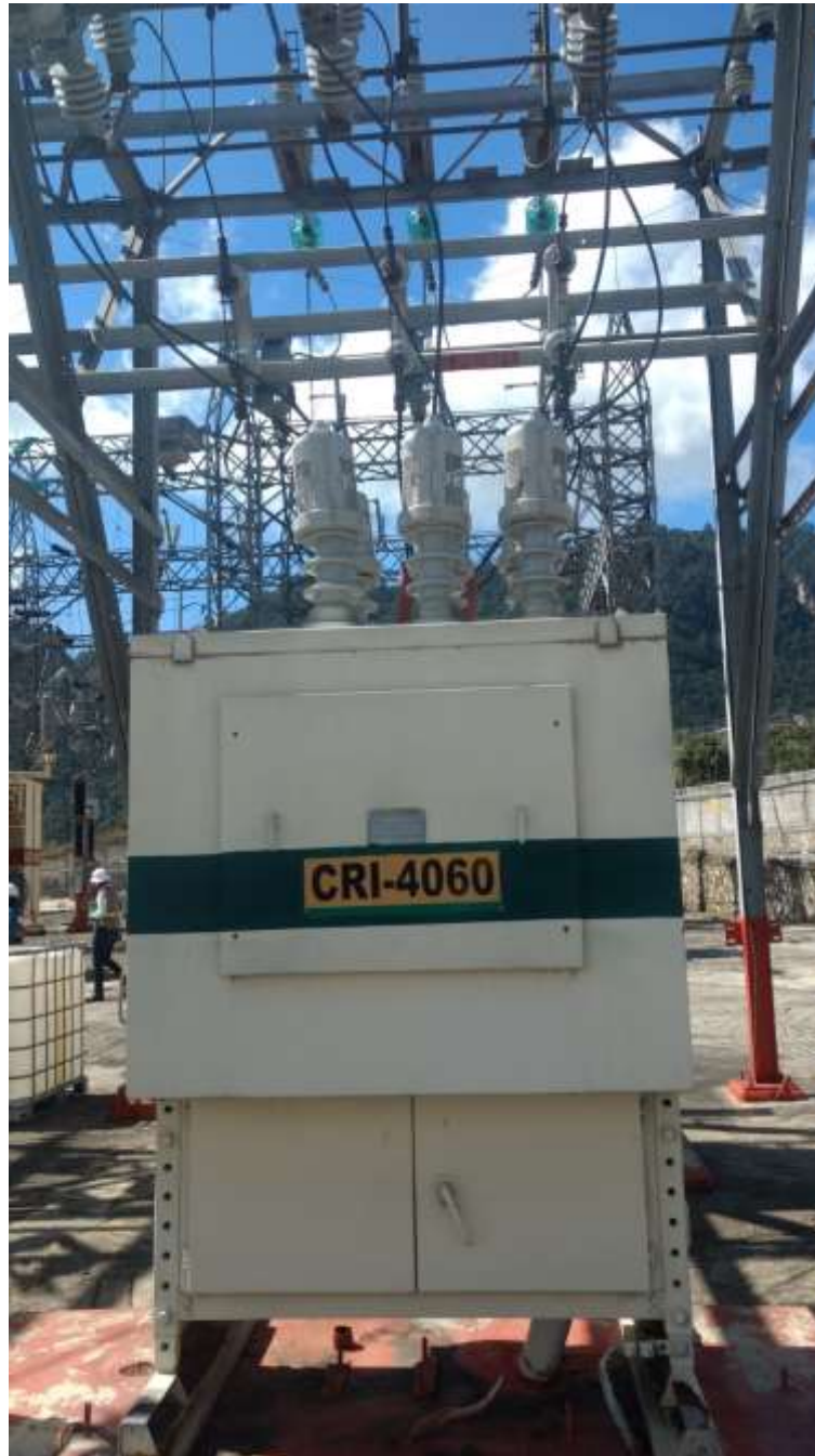
Figura 24 Interruptor de potencia en vacío CRI-4060
