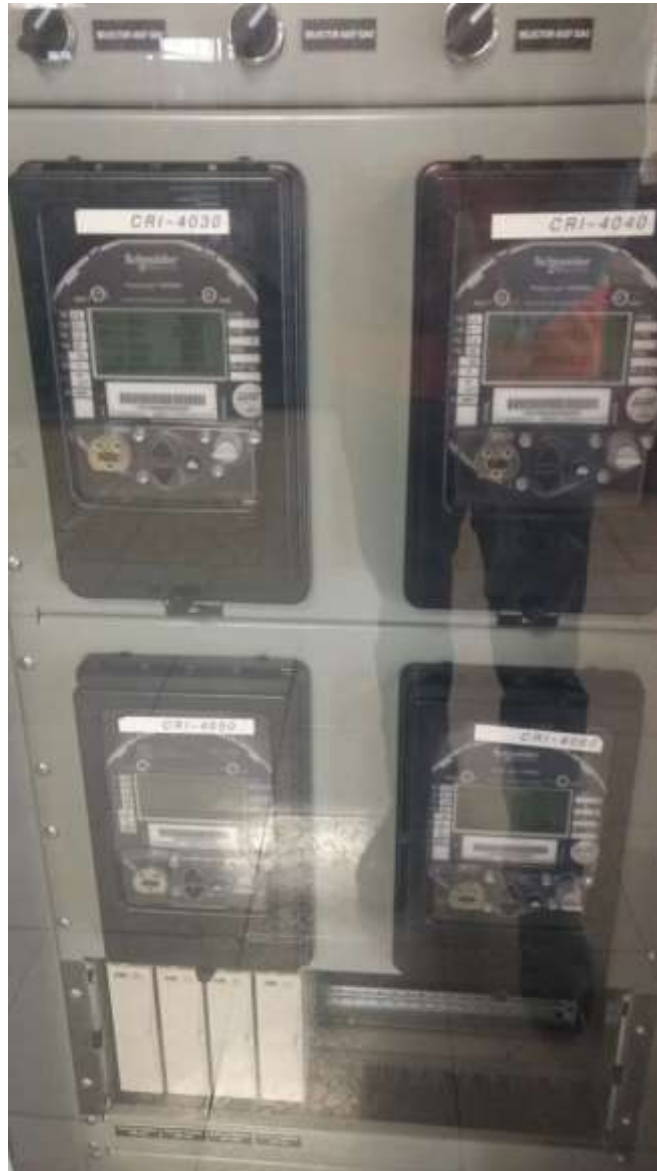
Figura 19 Multimeditores de energía para interruptores CRI (Marca ION)
