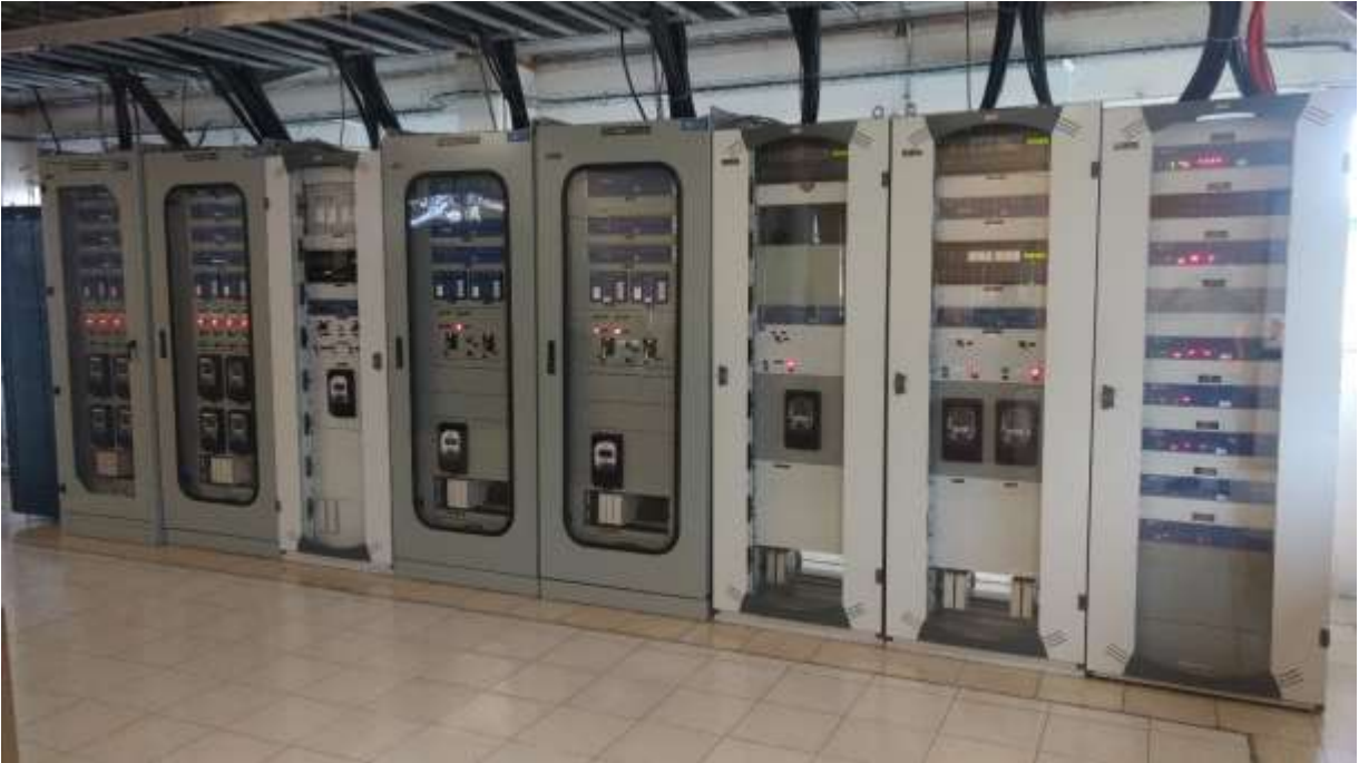
Figura 20 Centro de operaciones y monitoreo de la subestación San Cristóbal (SCO).
