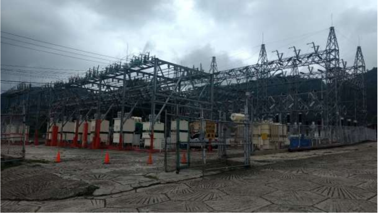
Figura 16 Subestación eléctrica San Cristóbal (SCO).
