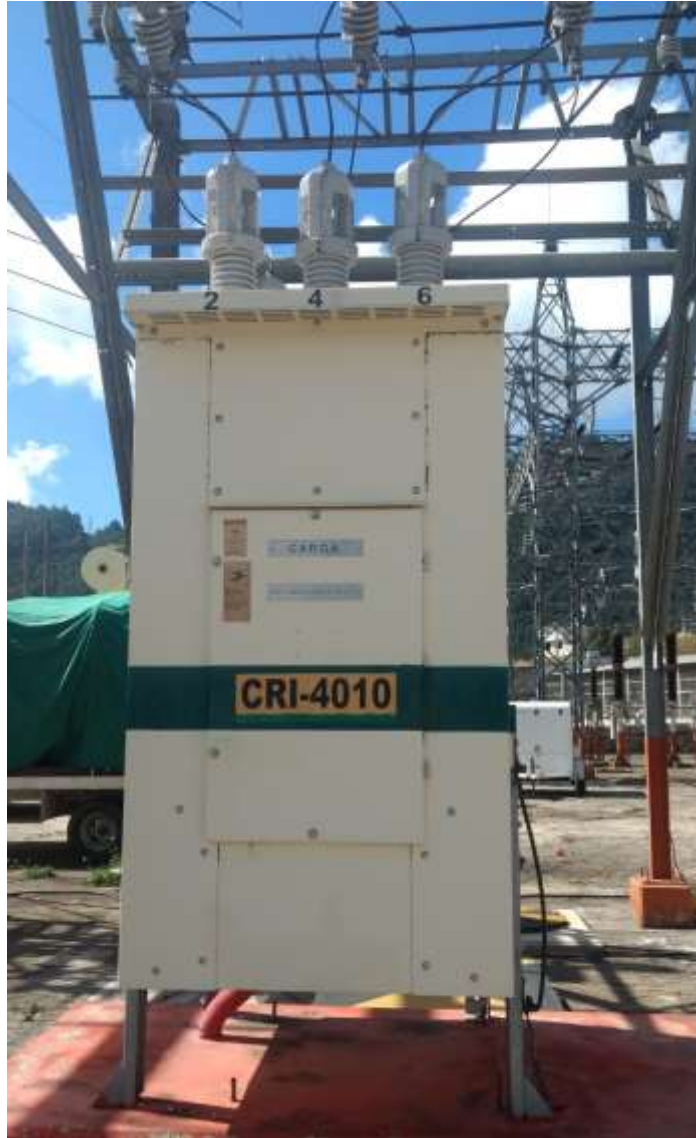
Figura 22 Interruptor de potencia en vacío CRI-4010
