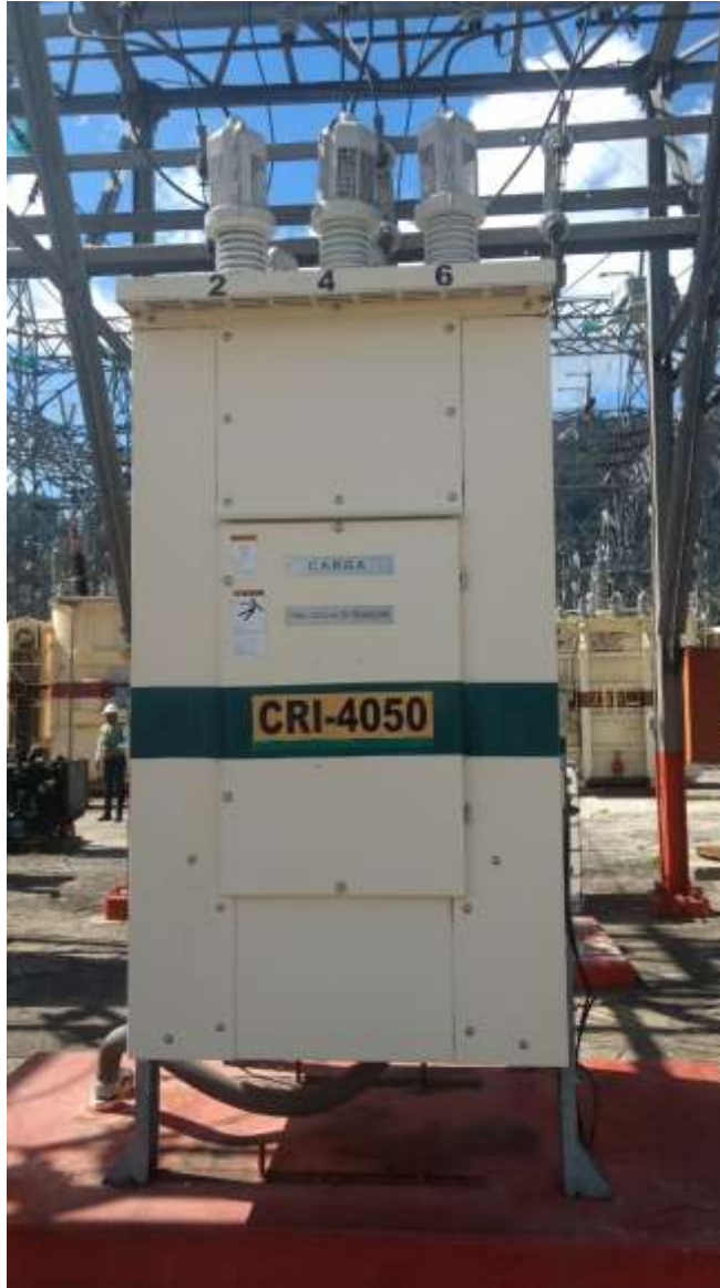
Figura 23 Interruptor de potencia en vacío CRI-4050
