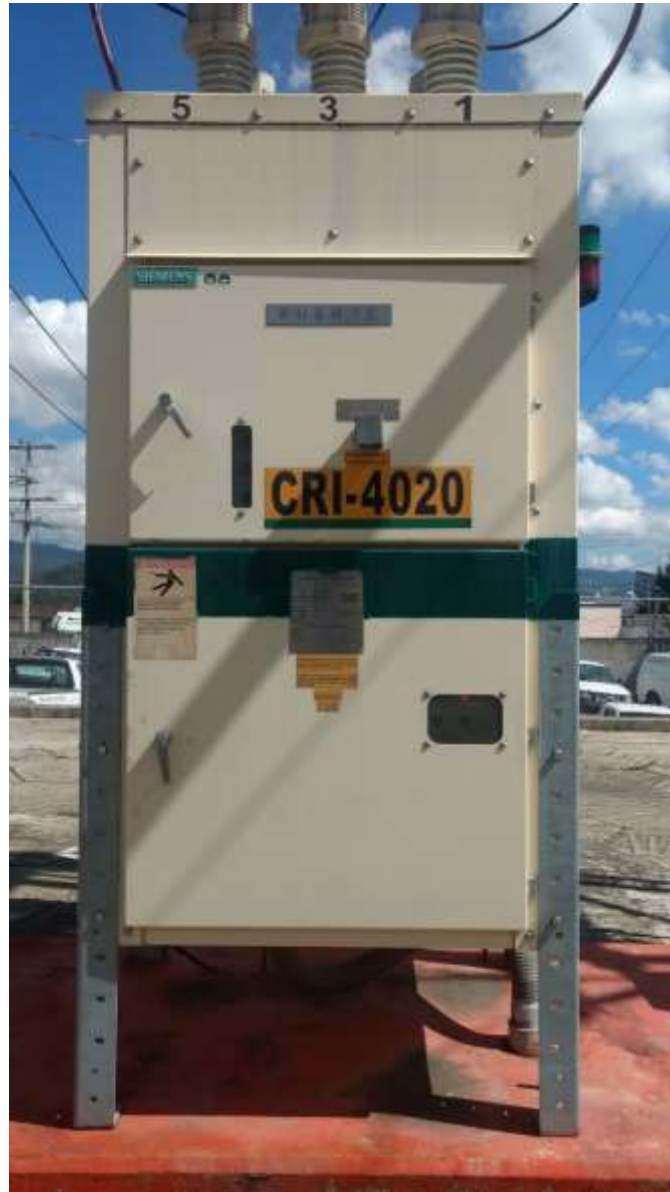
Figura 25 Interruptor de potencia en vacío CRI-4020
