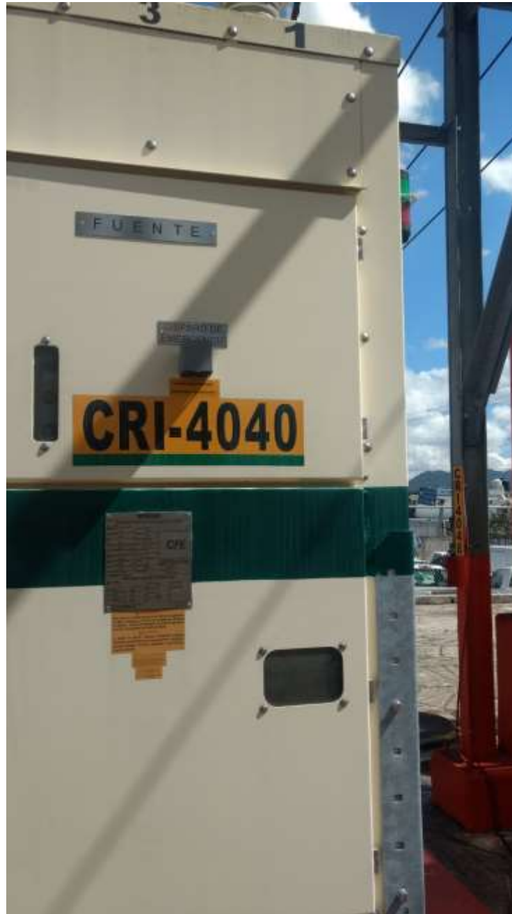
Figura 26 Interruptor de potencia en vacío CRI-4040
