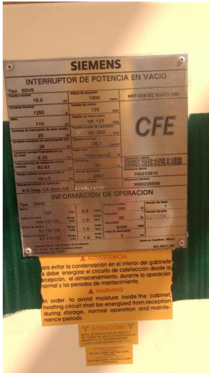
Figura 27 Placa de datos de los interruptores de potencia en vacío (CRI)
