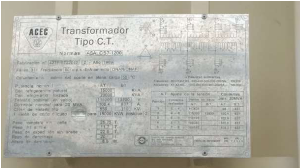
Figura 17 Datos de placa del Transformador T1. de la subestación SCO.
