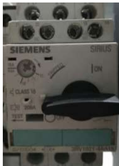
Anexo 6 Guardamotor instalado
