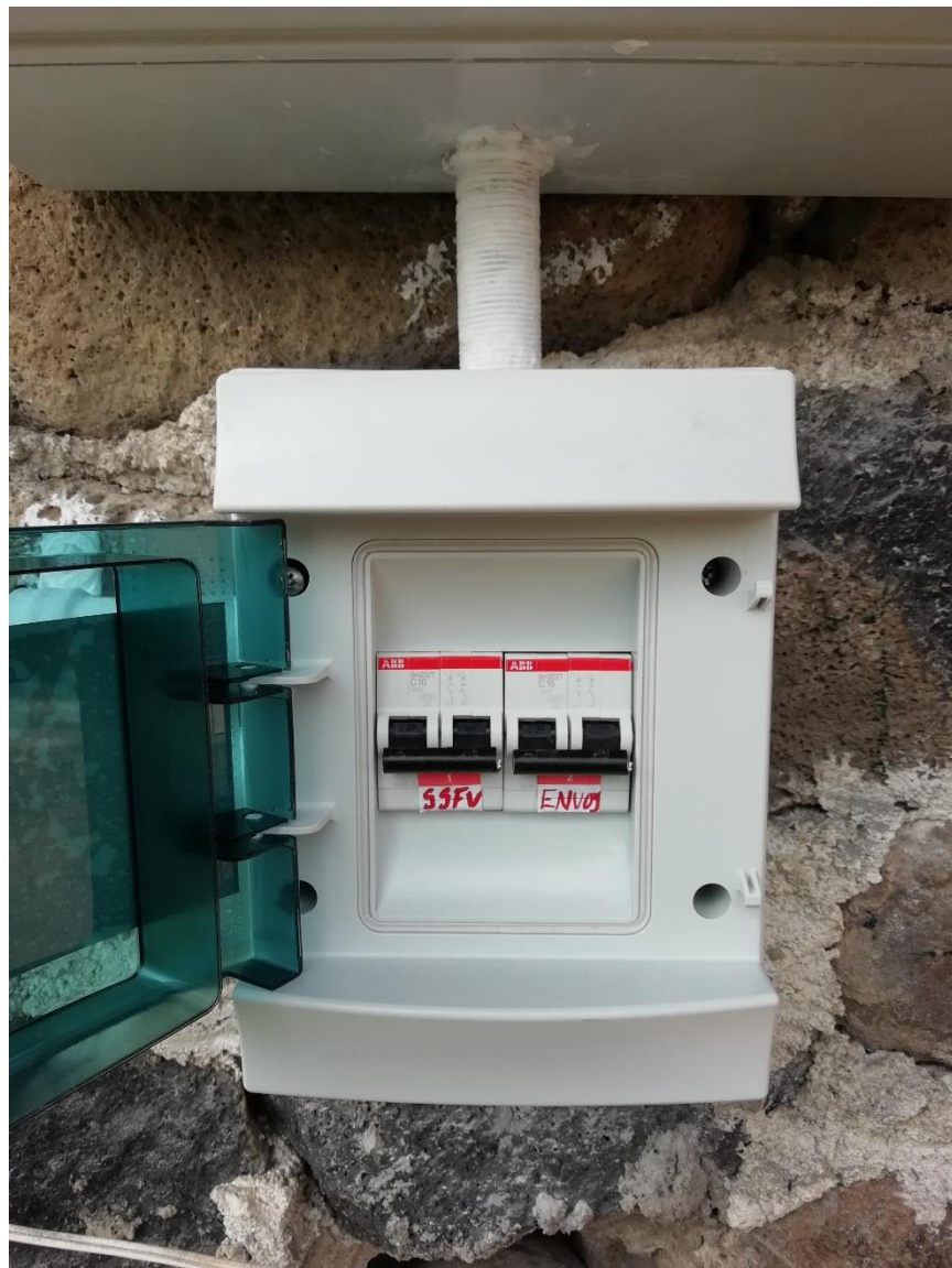
Protecciones de AC.
