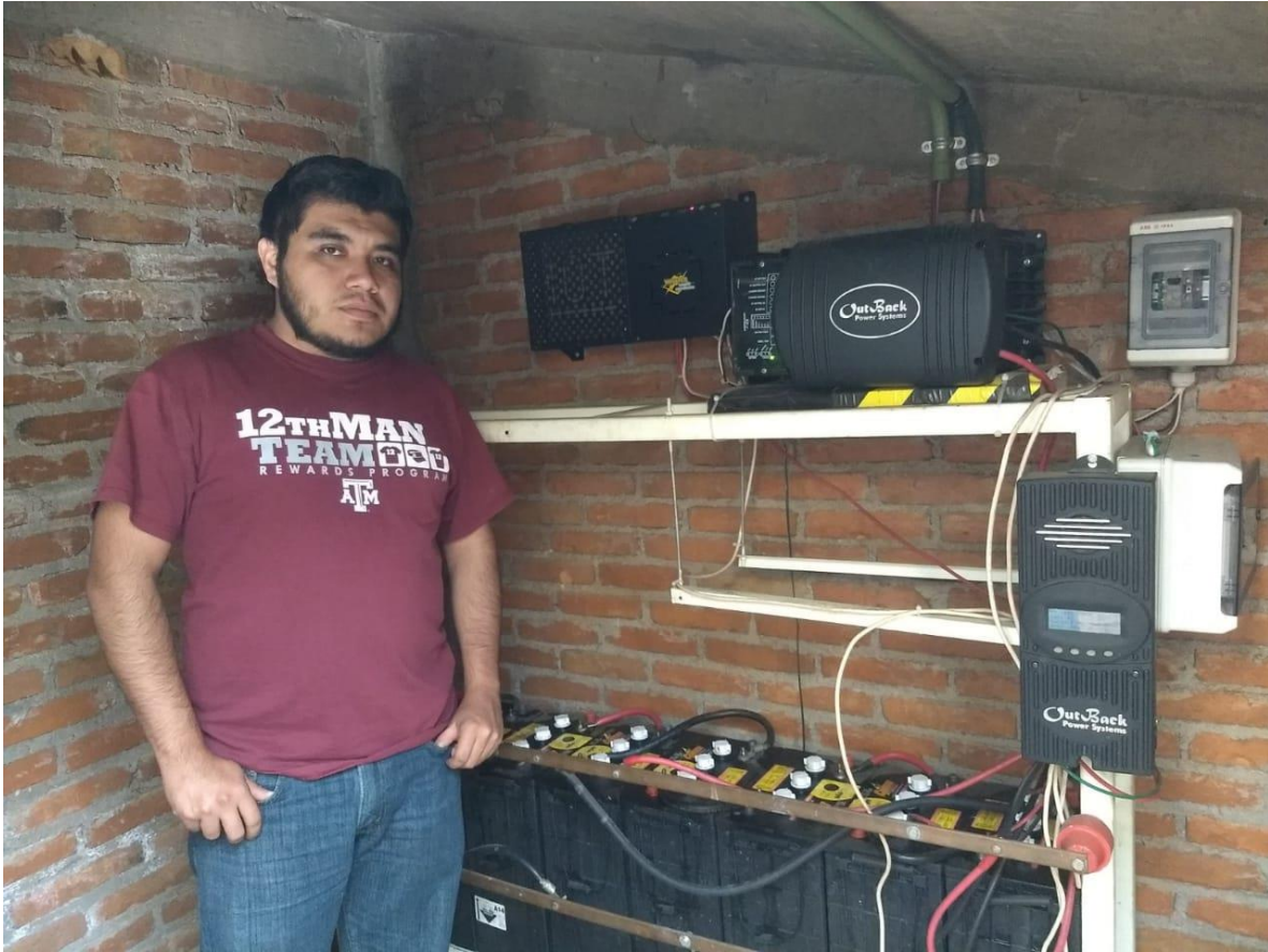
Conexión del sistema híbrido eólico fotovoltaico terminado.
