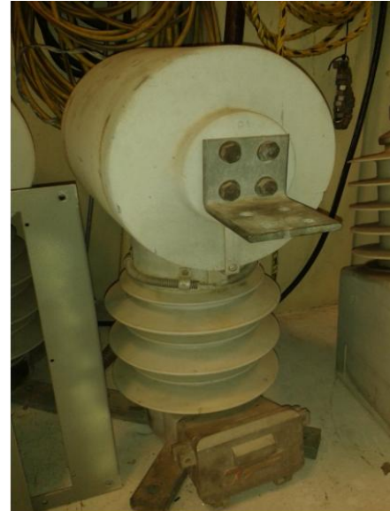
Figura 3.43 Transformador de corriente tipo pedestal para medición y protección en mal estado.
