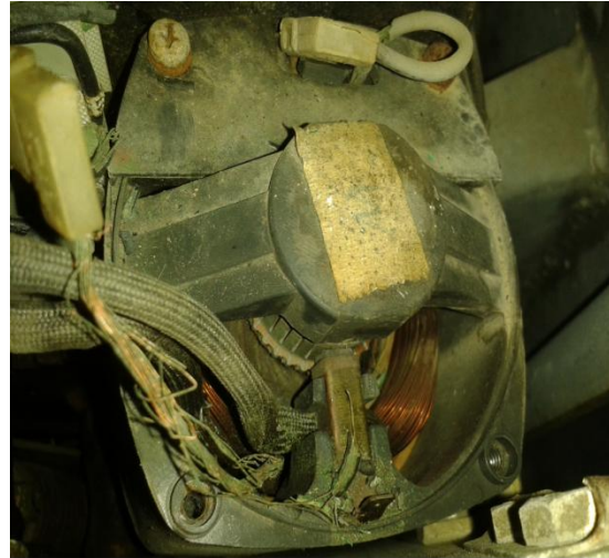
Figura 3.27 Falla en el motor de carga del circuito 4050
