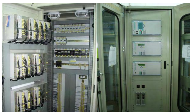
Figura 3.31 Tablero de control y protección =H10+R10.
