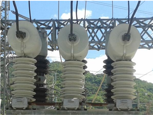
Figura 3.42 Transformador de instrumento tipo pedestal para medición y protección en operación.
