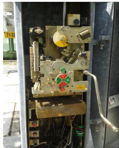
Figura 3.25 Mecanismo de accionamiento del interruptor 4020.
