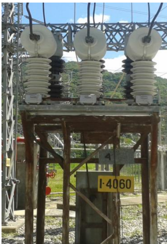
Figura 3.24 Base deteriorada del interruptor 4060.
