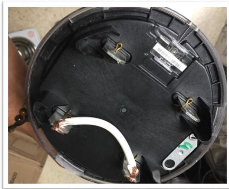
Imagen 20: base de medidor puenteada con conductor #12 AWG.
