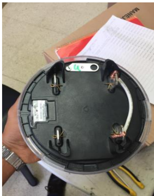
Imagen 21: puente en terminales del medidor con conductor #10.
