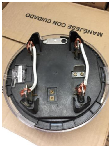
Imagen 28: puente en fases de medidor con calibre #10.
