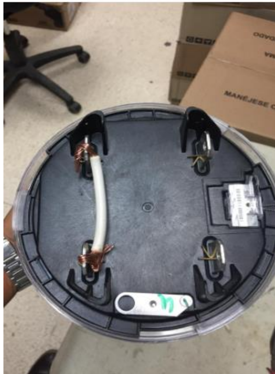
Imagen 22: puente en terminales del medidor con conductor #8.
