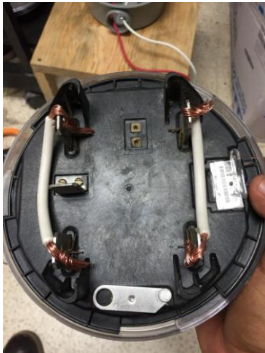
Imagen 29: puente en fases en terminales de medidor bifásico con calibre #8.
