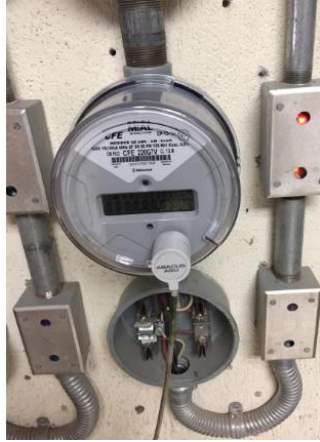
Imagen 38: medidor con “chupón” para ingreso de datos.
