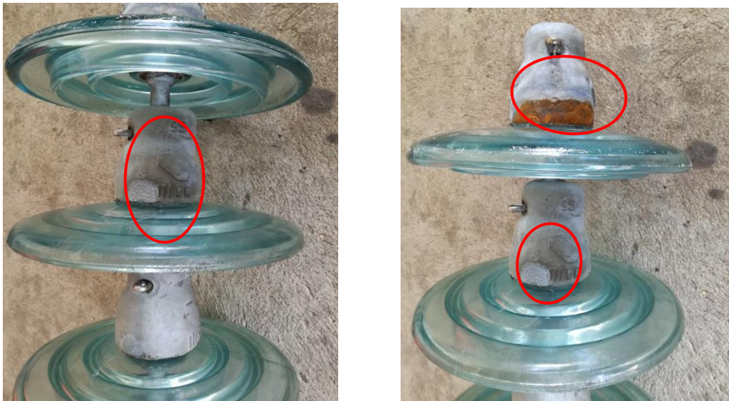
Figura 37.-Aislamiento de vidrio flameado de la línea 73750 estructura 4, fase B.
