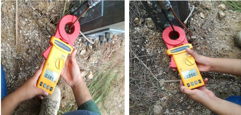
Figura 54.-La resistencia de la pata 1 tiene un valor de 0.390 \Omega , se detectan conectores de varilla inadecuados se requiere de soldadura para mejores resultados de uso.
