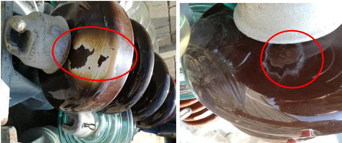
Figura 40.-Aislamiento de porcelana flameada en los primeros discos parte superior en la línea 73650 estructura 67, fase B.
