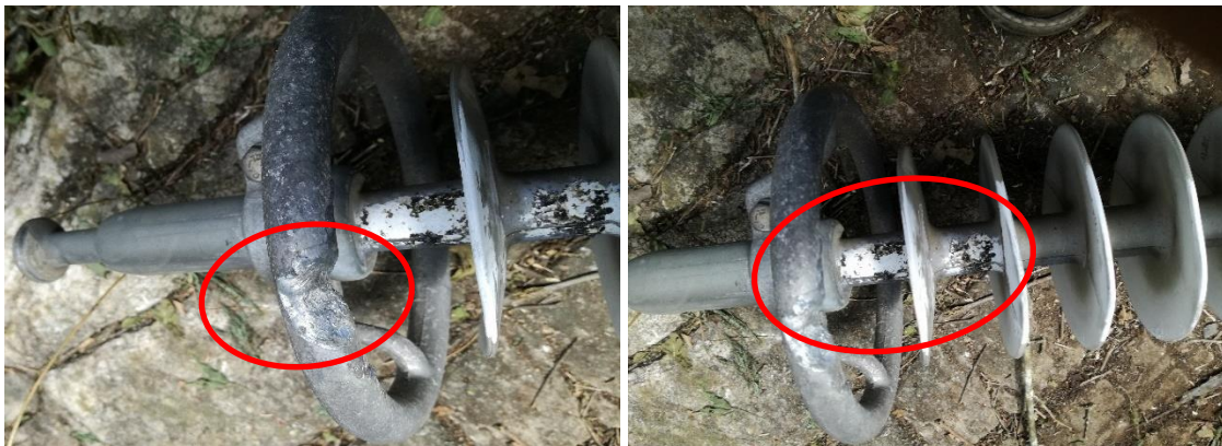
Figura 49.-Se encuentra zona destrozada en la parte inferior del aro metálico y material degradado en los discos del aislador epóxico.
