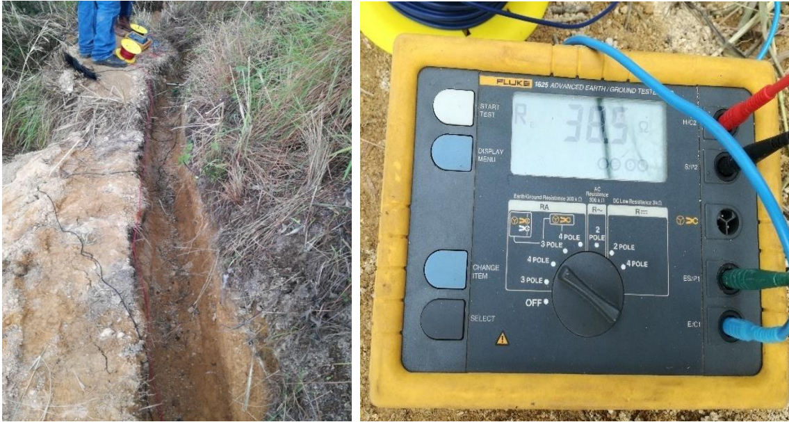
Figura 59.-Canal donde se realizaron las mediciones y resultados de la resistividad del suelo con distancia de 3 metros entre varillas.
