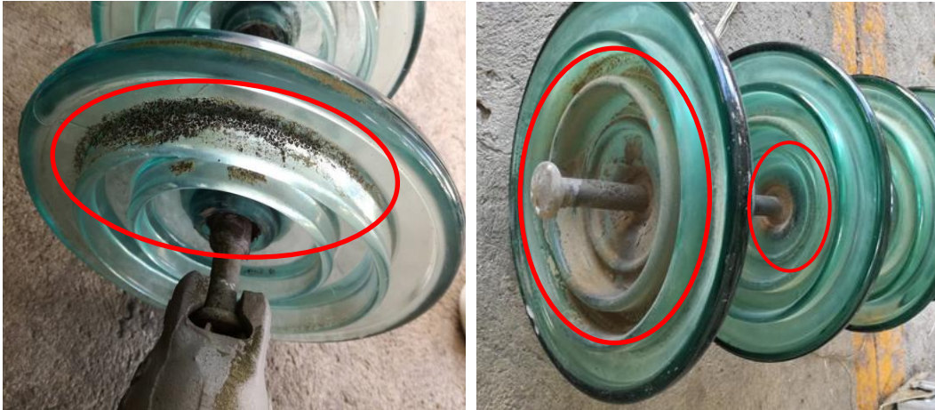
Figura 38.-Aislamiento de vidrio flameado con exceso de contaminación de la línea 73750 estructura 4, fase B.
