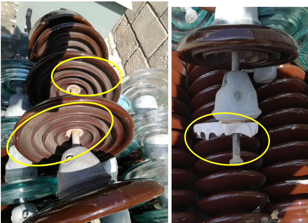
Figura 39.-Aislamiento de porcelana flameada con exceso de contaminación y último disco explotado en la línea 73650 en la estructura 67, fase B.
