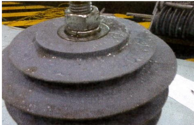
Figura 4.- El aislamiento polimérico presenta una hidrofobicidad HC4, conforme a la referencia de IEC, en los tres apartarrayos clase 1 que están en aparente buen estado
