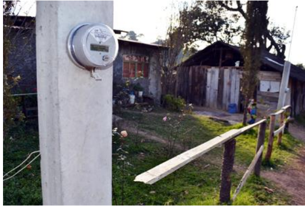
Fig. 4.2 Muretes y medidores instalados
