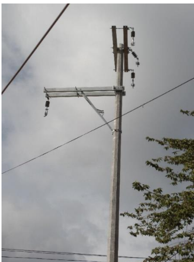
Fig. 3.2.7 Vestidos de poste en Media Tensión
