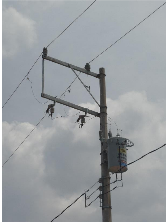
Fig. 3.2.13 Cortacircuitos fusibles instalados y conectados a transformador
