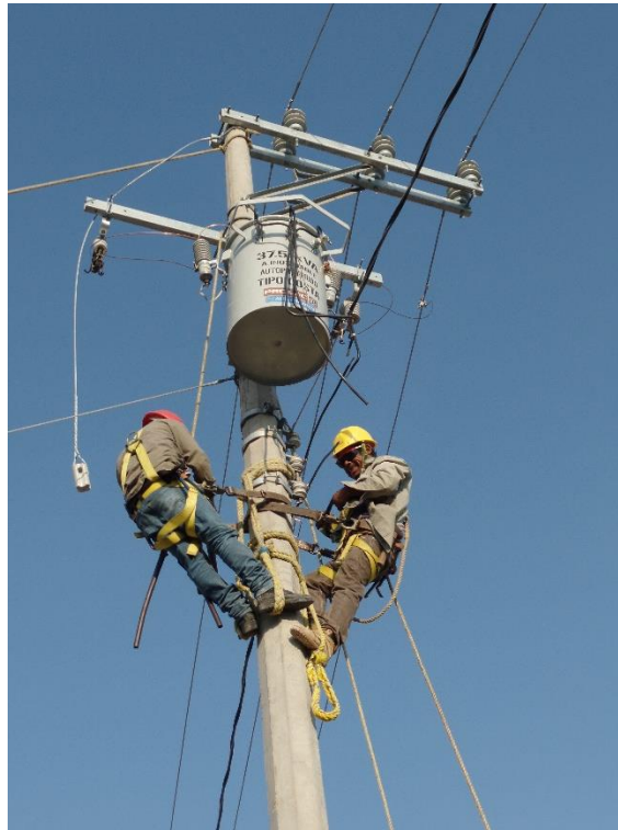
Fig. 3.2.12 Instalación de transformador
