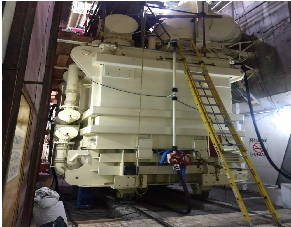
Imagen 1 Transformador de potencia 225 MVA
