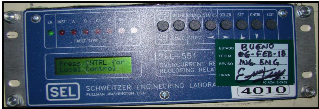
PPA protección primaria del Interruptor 4010. Relevador SEL – 551 protección de sobrecorriente
