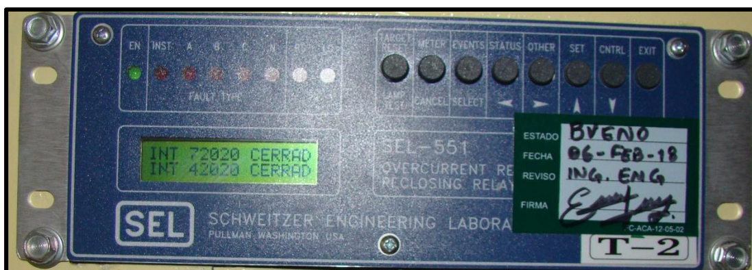
PRT2 (protección de respaldo de transformador) del interruptor 72020H y 42020L.Relevador SEL – 551 protección de sobrecorriente
