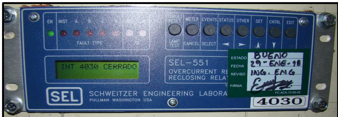
PPA protección principal del Interruptor 4030. Relevador SEL – 551 protección de sobrecorriente
