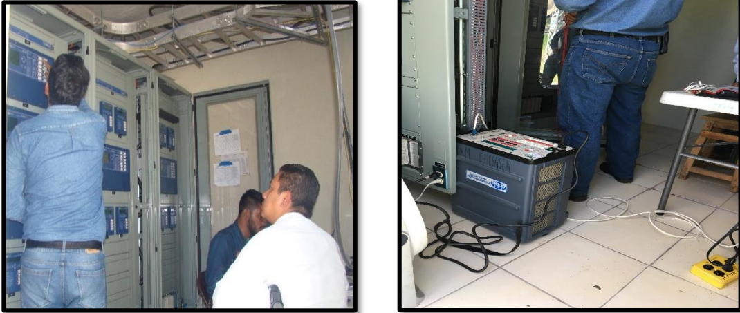
Figura 6. Pruebas a relevadores de protección.
