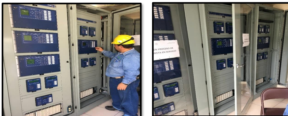
Figura 2. Tablero en caseta de control.
