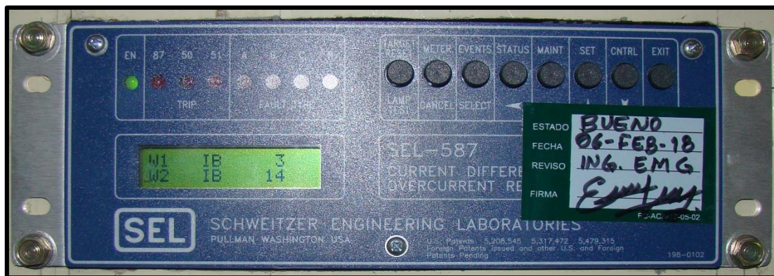
PPT2(protección principal transformador 2) Relevador SEL – 587 protección diferencial de transformador
