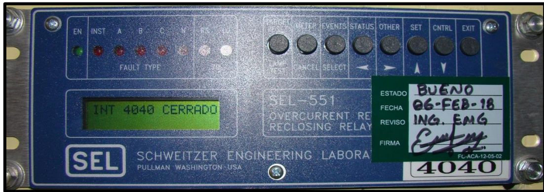
PPA protección principal del Interruptor 4040. Relevador SEL – 551 protección de sobrecorriente
