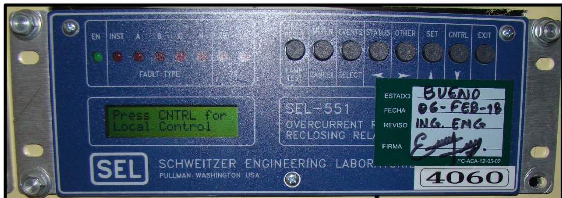
PPA protección principal del Interruptor 4050. Relevador SEL – 551 protección de sobrecorriente
