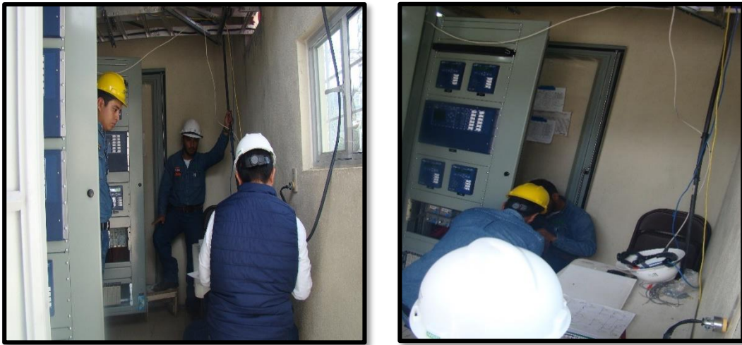
Figura 7. Pruebas operativas a tableros de protección
