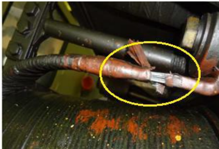
Figura 10. Falla en el sistema de aislamiento
