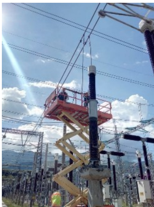
Figura 3.2.14 TPI puesto en la base, apretado y listo para conexiones en alta y baja tensión.
