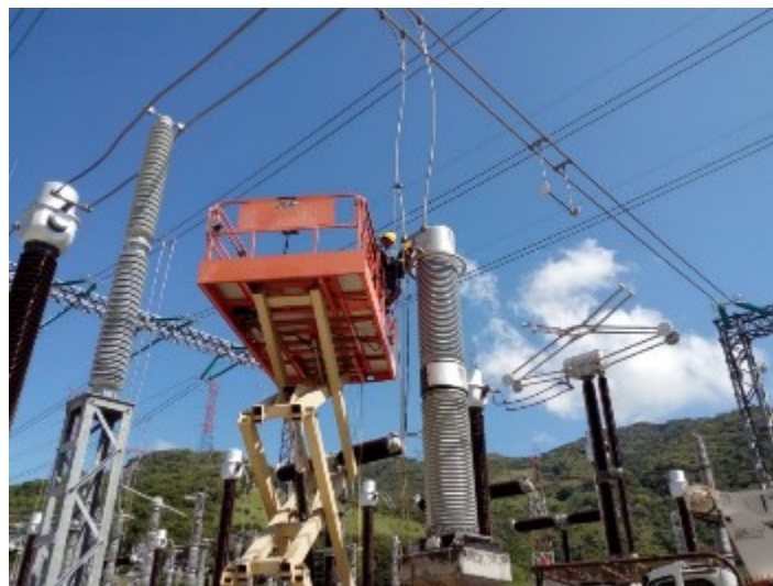
Figura 3.2.2 Desconexión del lado primario de alta tensión
