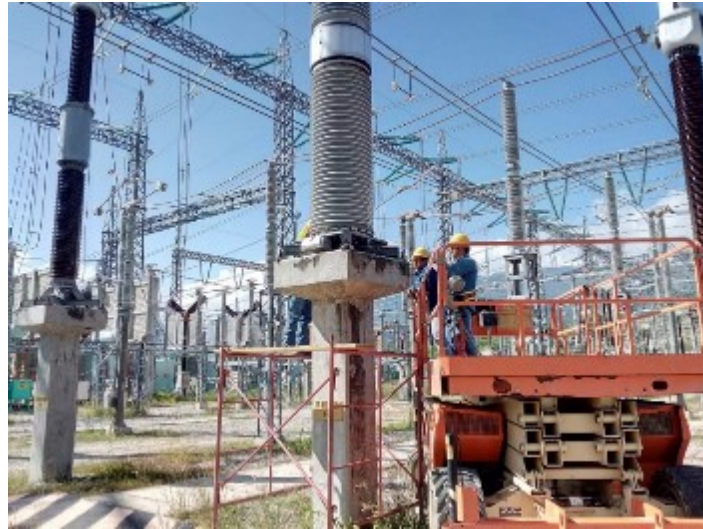
Figura 3.2.3 Aflojamiento de tornillos en la base del TPI
