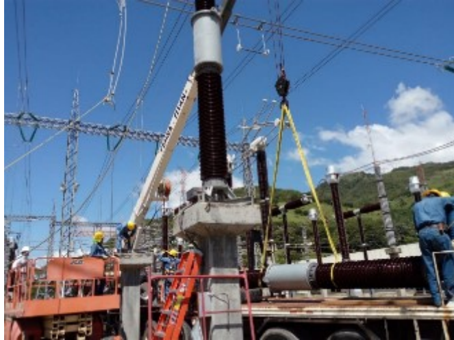
Figura 3.2.11 Levantamiento del TPI con la grúa en comunicación con el operador de grúa.
