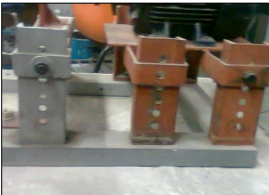
Figura 96 c.- Tuercas de unión faltantes.
