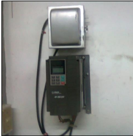
Figura 130.- Conexión y alimentación del variador de frecuencias.
