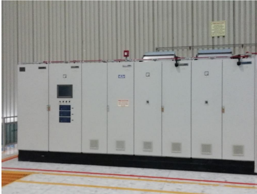
Fig. 2.4 regulador de voltaje automático (AVR)
