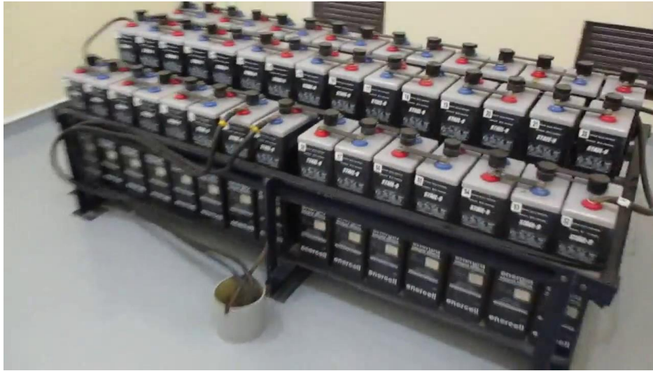
Fig. 2.3 banco de baterías
