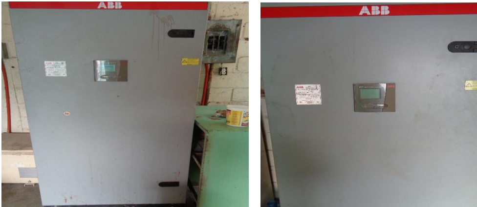
Ilustración 20- Bancos de capacitores de capacidad para los equipos que operan actualmente
