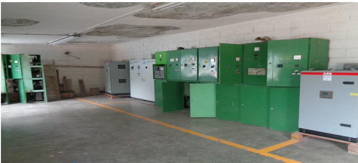
Ilustración 25- Arrancadores de la planta 3 nueva
