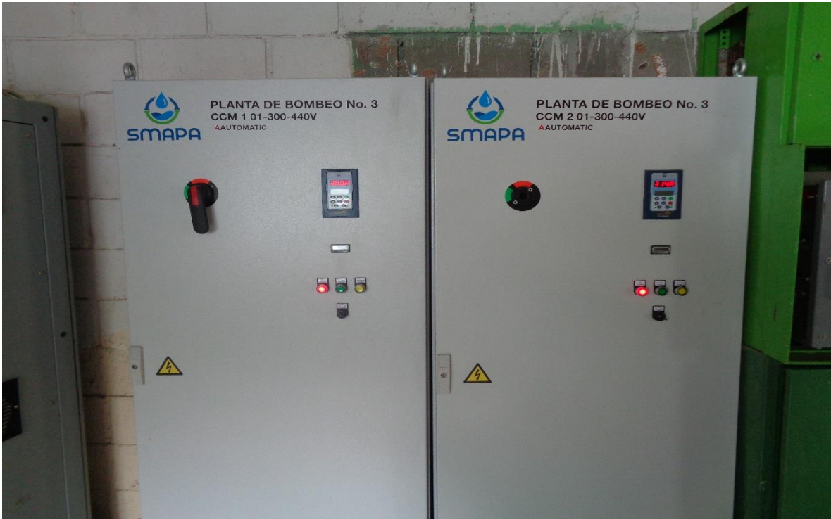
Ilustración 26- Arrancadores de estado solido
