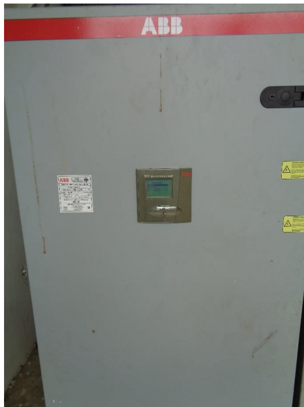
Ilustración 12- Banco de capacitores con la capacidad de los equipos actuales
