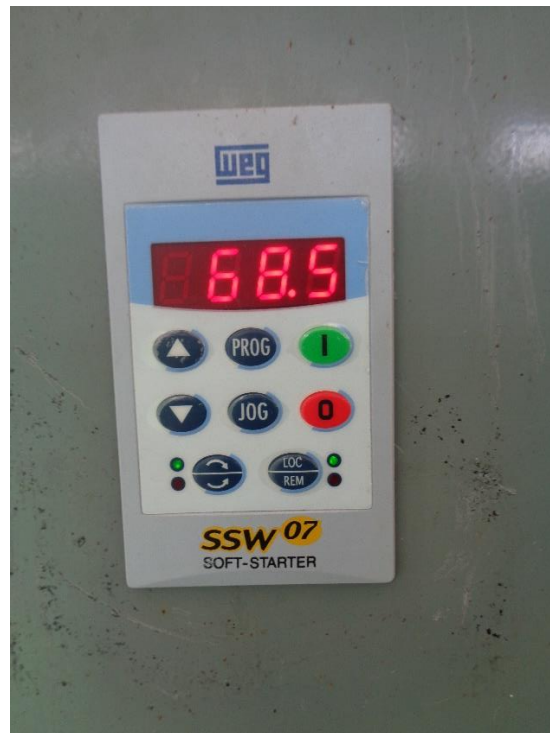
ilustración 4- Arrancador nuevo de estado solido
