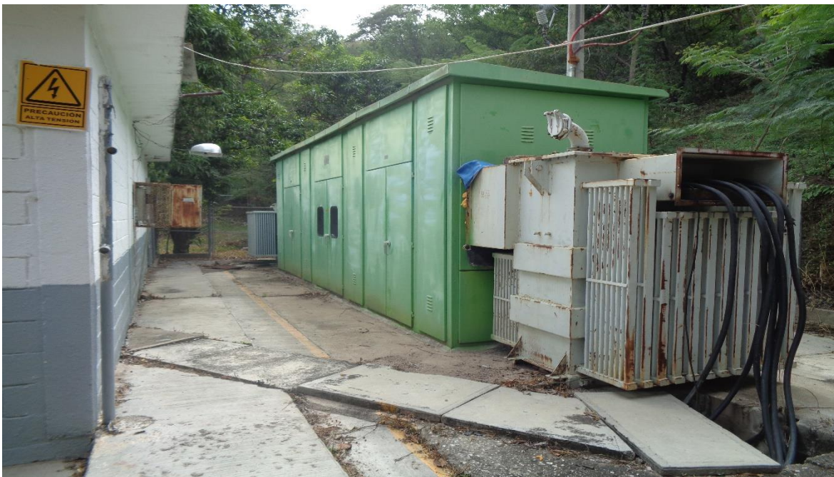
Ilustración 24- Subestación compacta de dos transformadores de 1000 KVA
