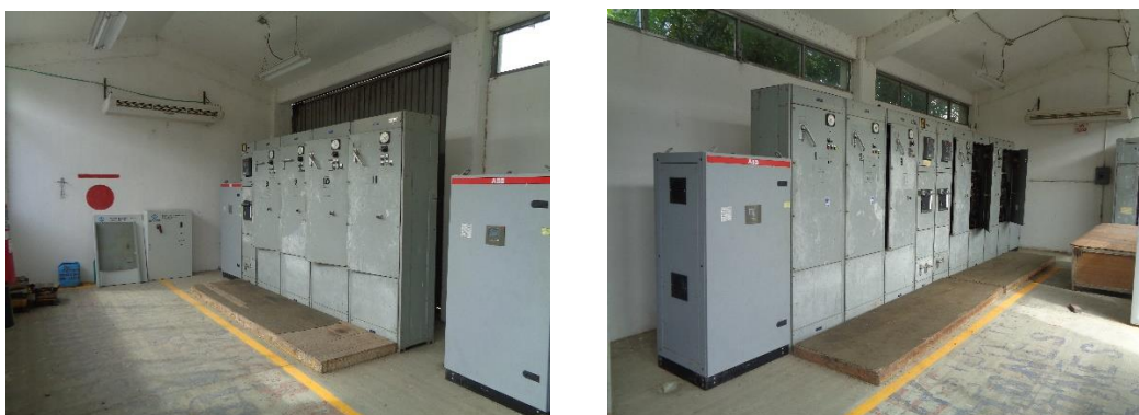
Ilustración 9- Arrancadores para planta 1 sedimentadores
