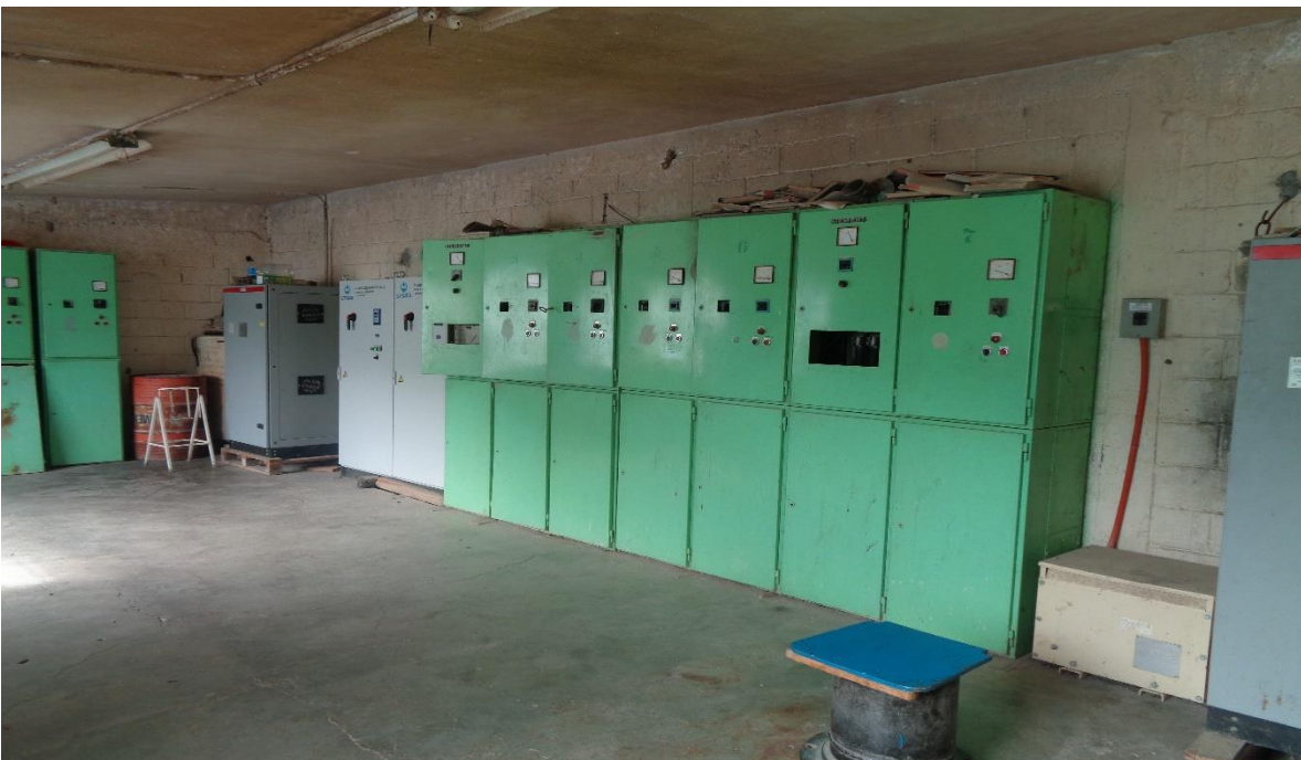
Ilustración 17- Arrancadores planta 2 nueva
