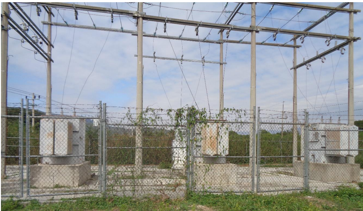
Ilustración 8 – Transformadores existentes y óptimos para seguir operando
