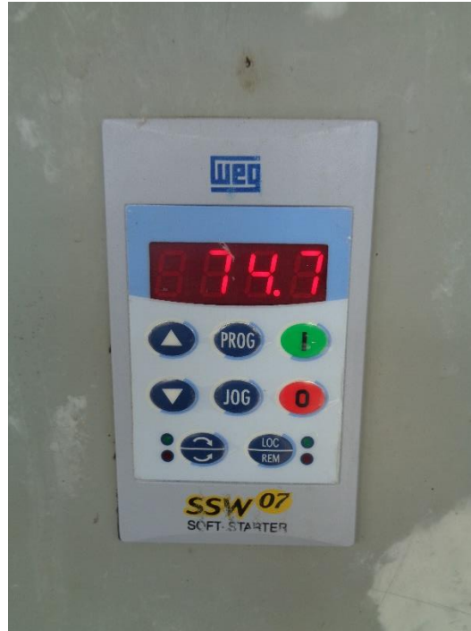
ilustración 11- Arrancador nuevo de estado sólido
