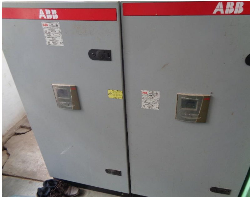
Ilustración 2- Banco de capacitores para utilización de equipos actuales en operación
