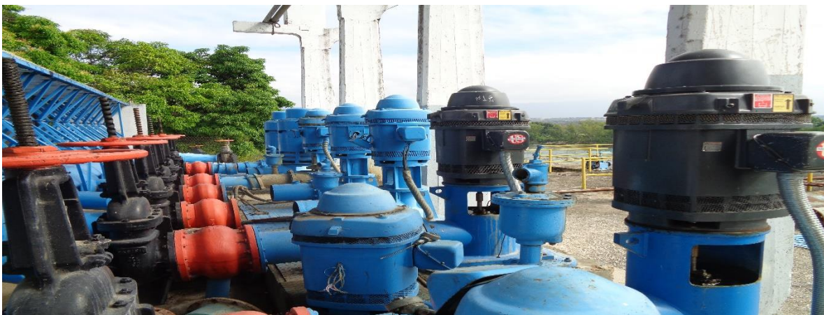
Ilustración 7- Línea en la que se fue cambiando motores verticales
