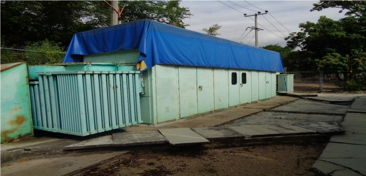
Ilustración 16- Subestación compacta de dos transformadores de 1000 KVA
