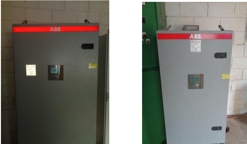
Ilustración 28- Bancos de capacitores con la capacidad para os equipos que operan actualmente
