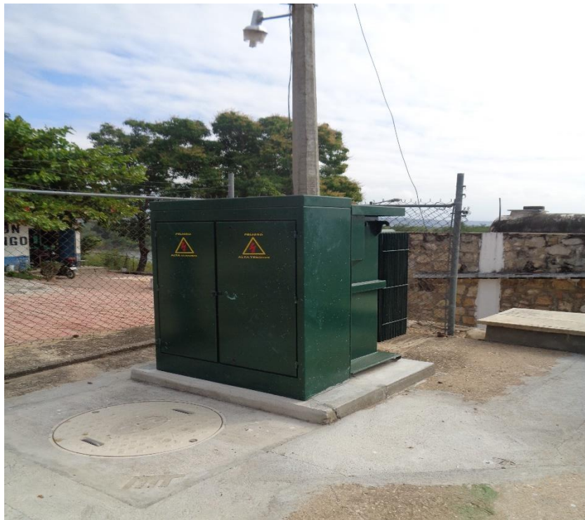
Ilustración 1- Transformador de 500 KVA
