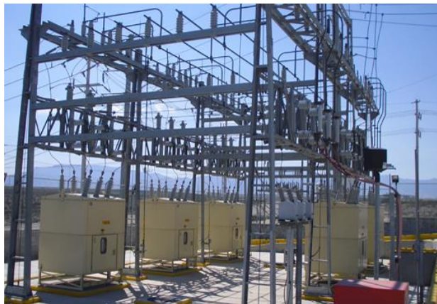
Fig.2.6 Subestación tipo abierta.
