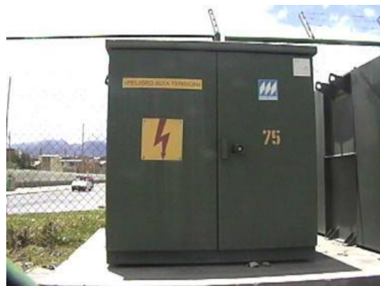
Fig.2.7 Subestación tipo pedestal.
