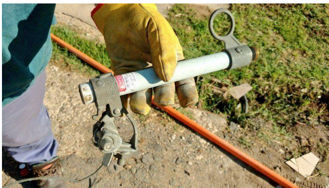
Fig 2.4. Fusible quemado por exceso de carga.
