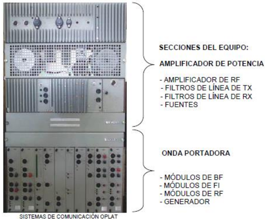
FIGURA 3. 3123 EQUIPO OPLAT ESB 500
