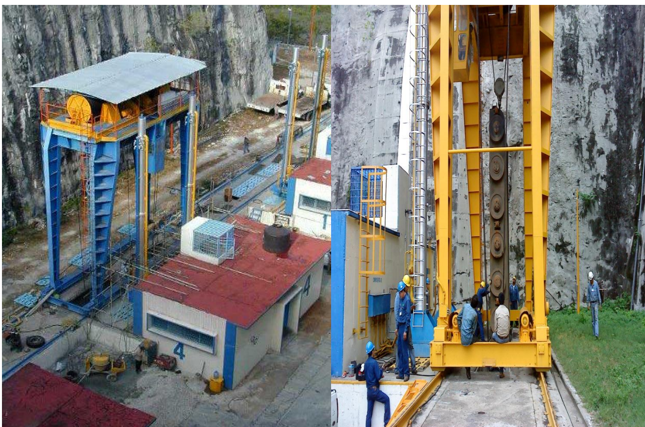
Figura 9.- Casetas de control de obra de toma y grúa pórtico para operar las compuertas Auxiliares.
