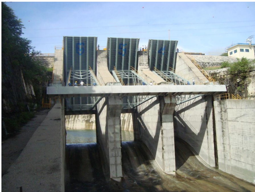
Figura 6.- Compuertas de vertedores
