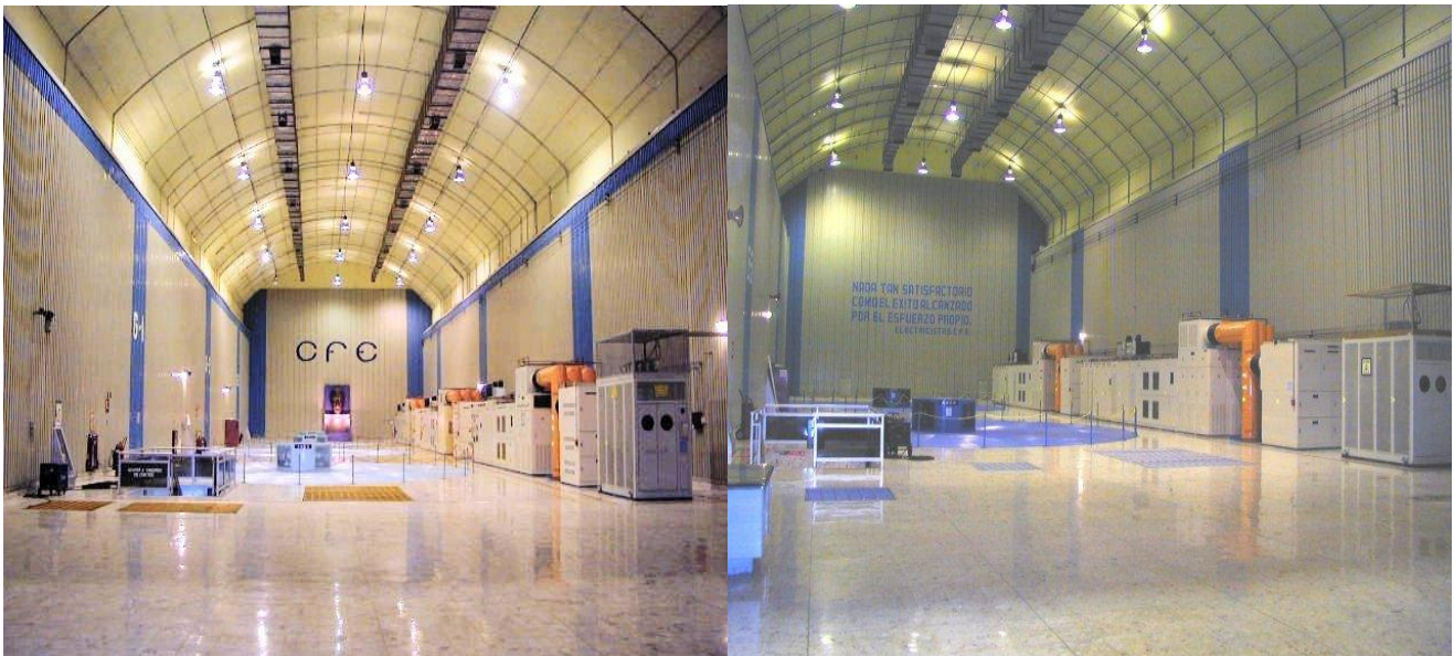
Figura 10.- Casa de máquinas 1ª y 2ª Etapa.
