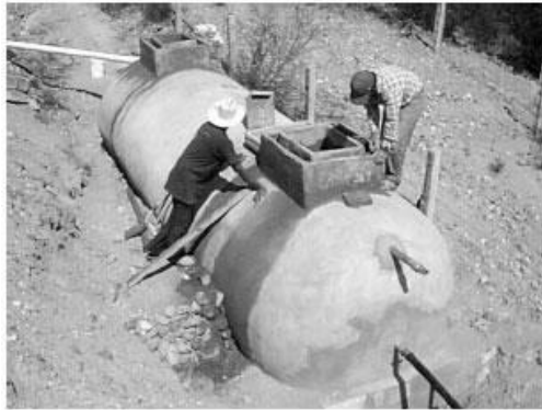
fig.2.3 Imagen de un tanque de sistema mixto
