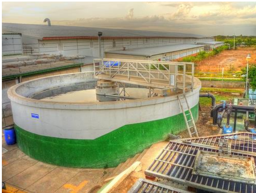
fig.2.6 Tanque de una unidad de clarificación
