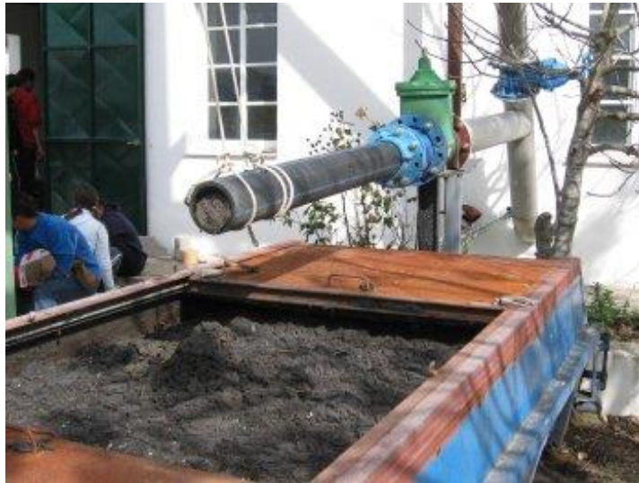
fig.2.8 Tanque de unidad de lodos
