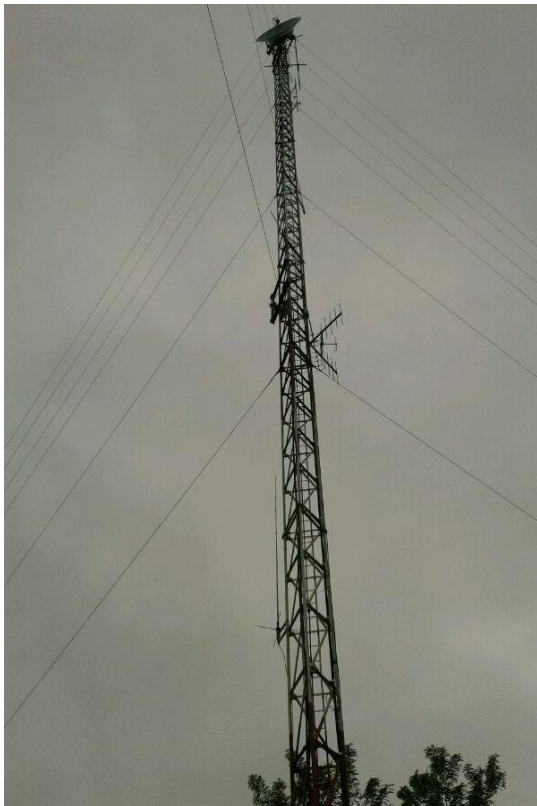
Figura 3.4.1 Repetidor de comunicación
