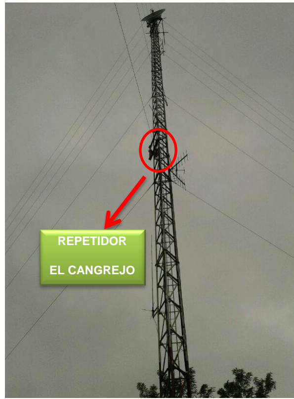
Figura 3.4.2 Repetidor de comunicación El Cangrejo.
