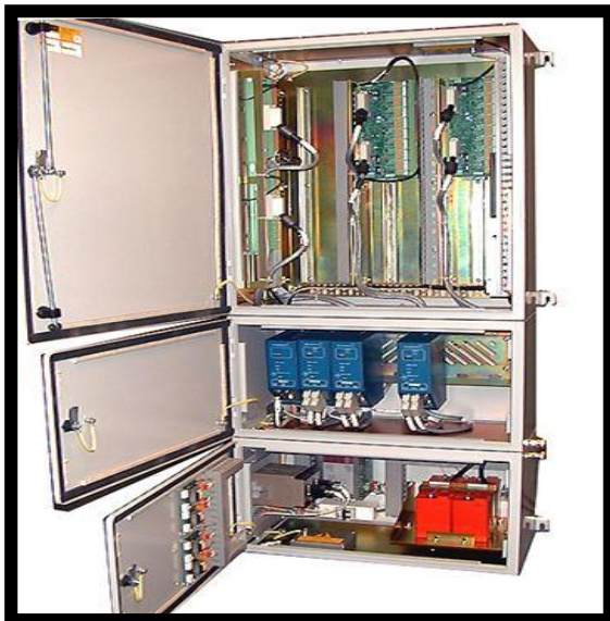
Figura 2.5.1 UTR de subestación
