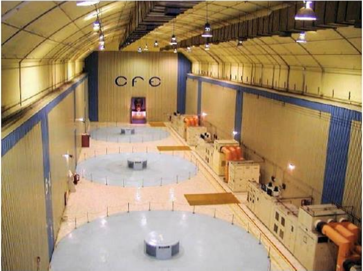
Figura 2.- Casa de máquinas.
