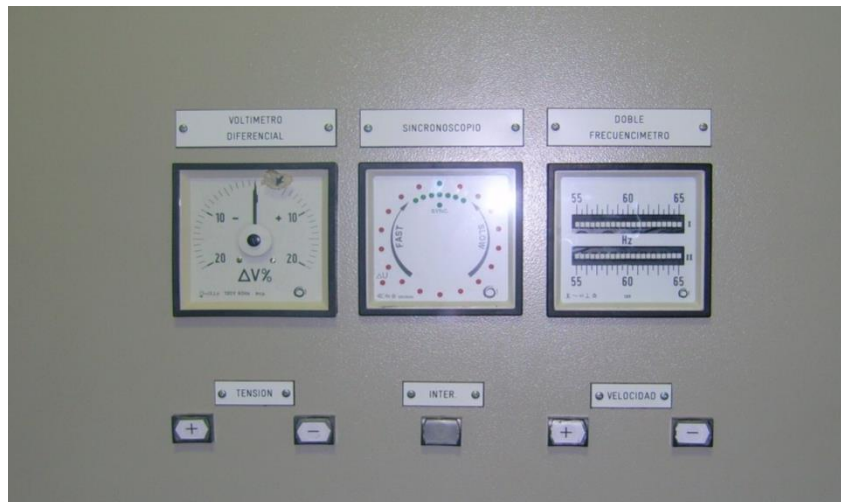
Fig. 3.6 Instrumentación de campo- Voltímetro diferencial, sincronoscopio, doble frecuencímetro.
