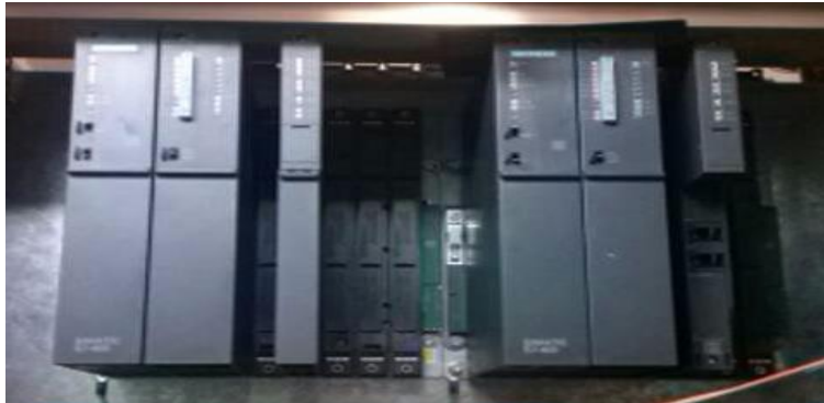
Fig. 3.18 PLC S7 400H.
