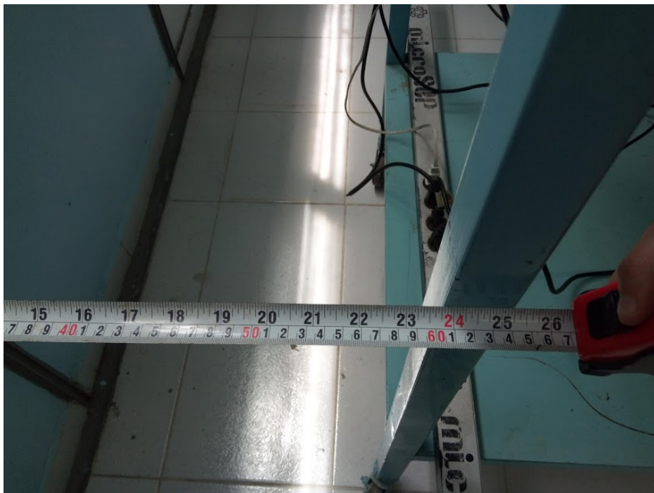
Figura 3.14: Medición del área de operación del rack.
