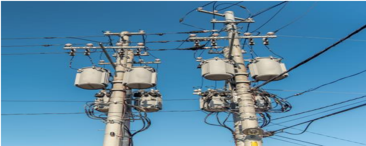
Figura 2.2 Transformador para distribución de energía eléctrica.
