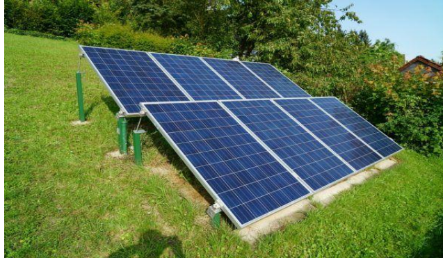
Figura 2.5 Energía solar fotovoltaica.
