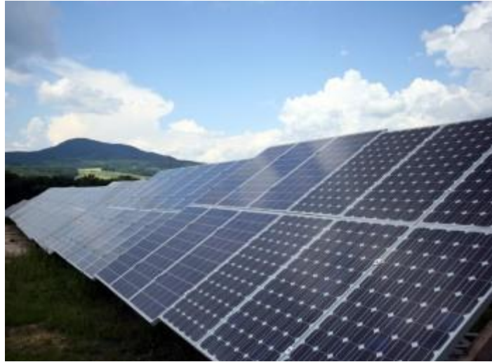
Figura 2.2 posición del panel fotovoltaico.
