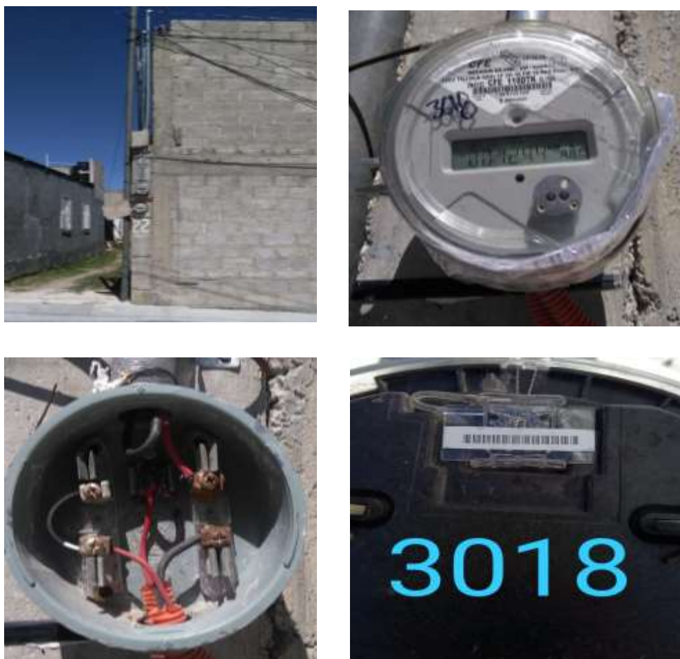
Fig. 3.20, Panorámica del lugar y del estado del medidor 118DTK, ubicado en el ciclo 05 en la ruta 500, CDA ROMERILLO Núm. 23, CP.29264, San Cristóbal de las Casas, Chiapas
