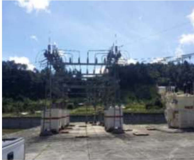
Figura 2.1, subestación San Cristóbal de las Casas
