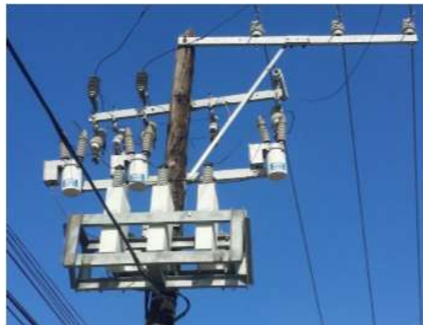
Figura 2.5, Banco de capacitores
