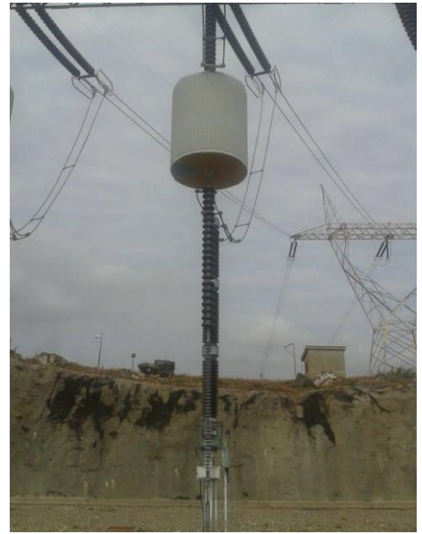
Fig 3.23 Trampa de Onda instalada para OPLAT MMT.
