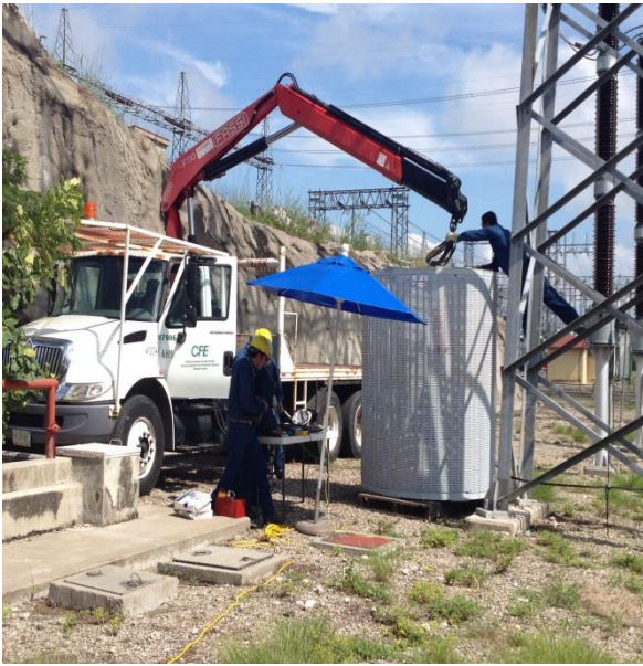
Fig 3.22 Barridos de frecuencia en Trampa de Onda e instalación de la misma.
