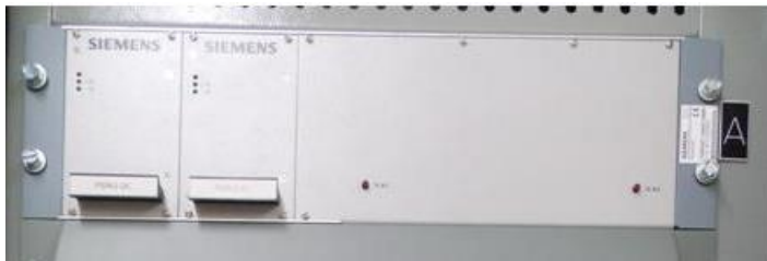
Fig 3.1 Vista exterior del gabinete
