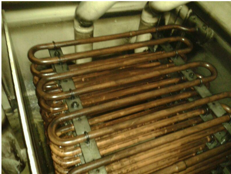
Imagen 4.1. Intercambiador de calor a adaptar.
