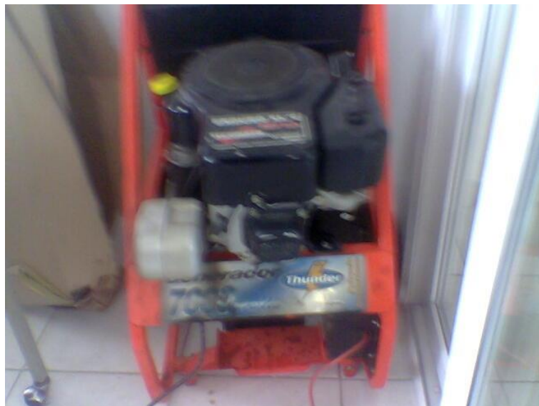
GENERADOR DE ENERGÍA
