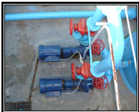
Img. 3.12 Bombas de transferencia
