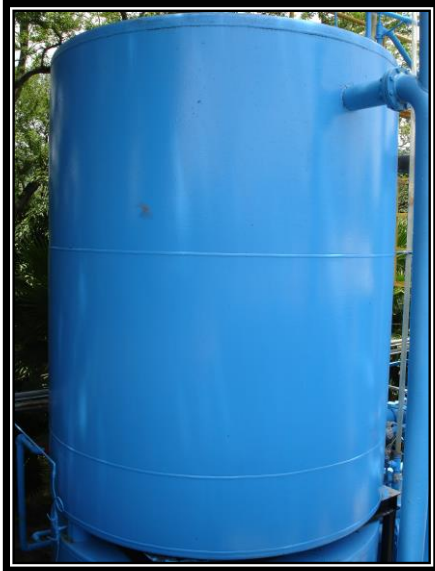
Img. 3.16 Tanque de almacenamiento Filtro 1
