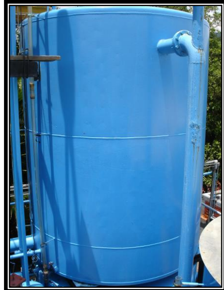
Img. 3.17 Tanque de almacenamiento Filtro 2
