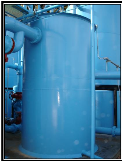
Img. 3.10 Tanque de transferencia
