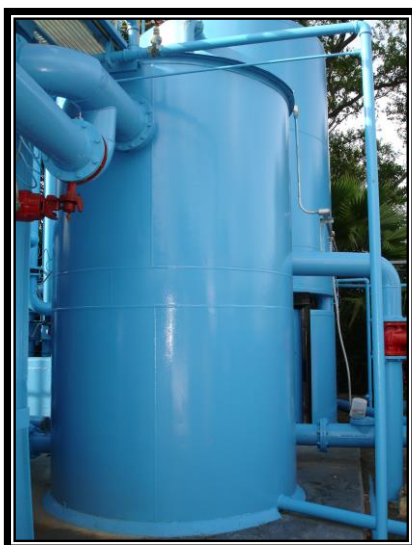
Img. 3.5 Tanque de transferencia
