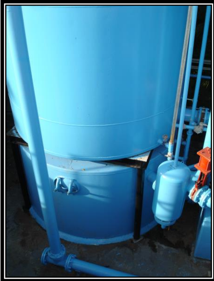
Img. 3.19 Filtro y tanque de almacenamiento
