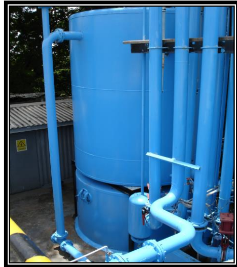
Img. 3.8 Filtro y su tanque de almacenamiento
