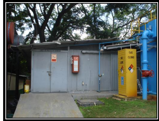
Img. 3.2 Caseta de adición de reactivos
