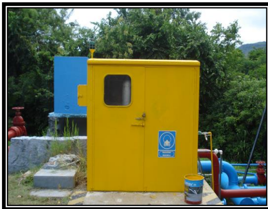
Img. 3.9 Caseta de post cloración
