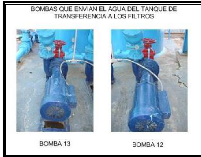
Fig. 3.4 Bombas de transferencia
