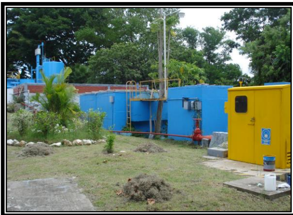
Img. 3.18 Área de post cloración
