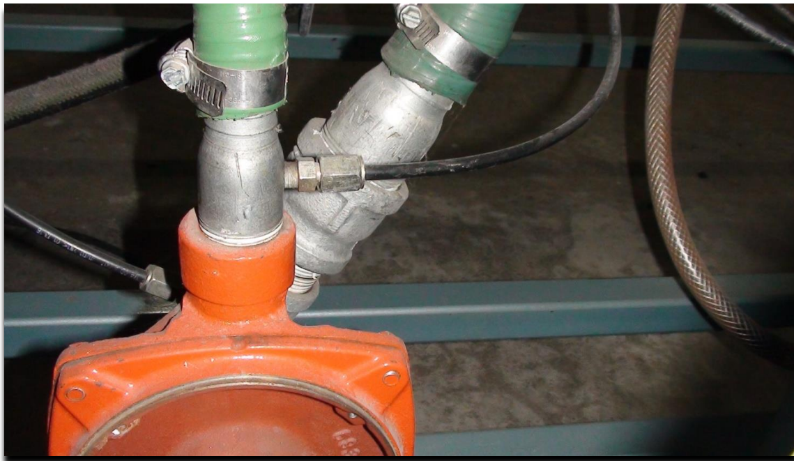
Imagen 8.1.4 conexión de la bomba de engranes hacia el manómetro de descargar correspondiente
