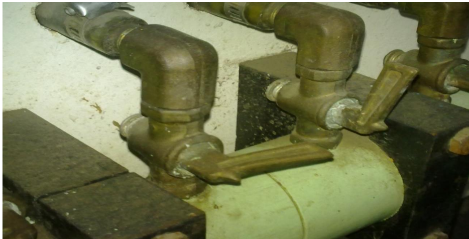
Imagen 8.5.1 Grifos del Tablero de pérdidas por fricción
