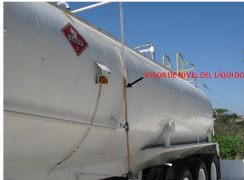
Figura.2-3.-Medidor de nivel de tanque.
