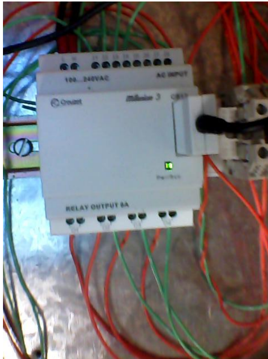
Figura.4-5.-El PLC trabaja de forma automática.
