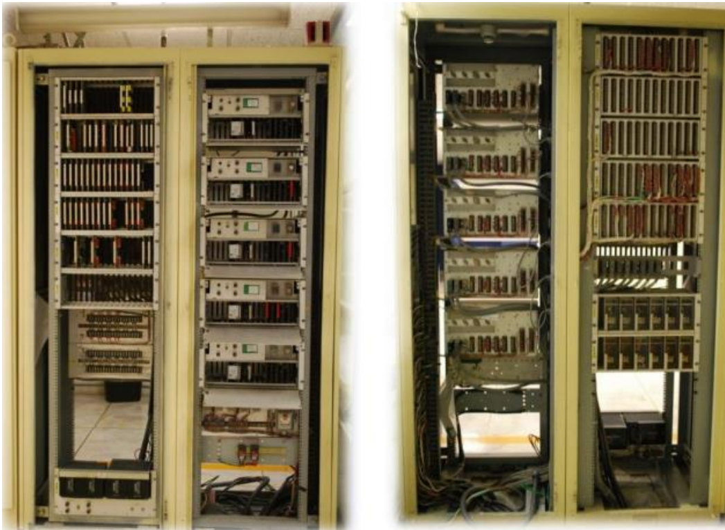
Fig.1.2 Equipo a modernizar UTR y controladores AGC
