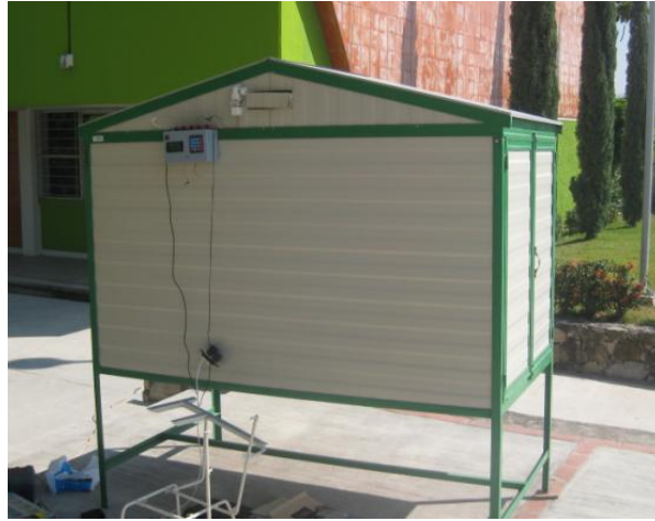
Figura 46: Sistema Instalado en la Deshidratadora
