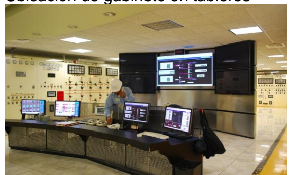
Fig 3.6 Ubicación de Gabinete en área de tableros
