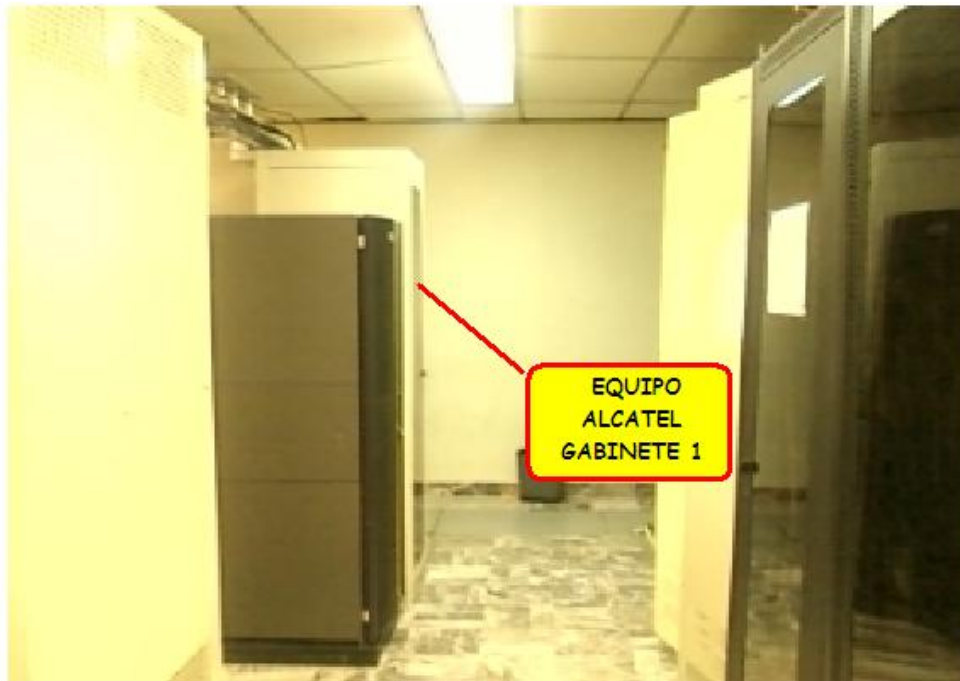
Figura 3.7 Ubicación del Alcatel en la sala de equipos (sala carrier) en la subestación MMT.
