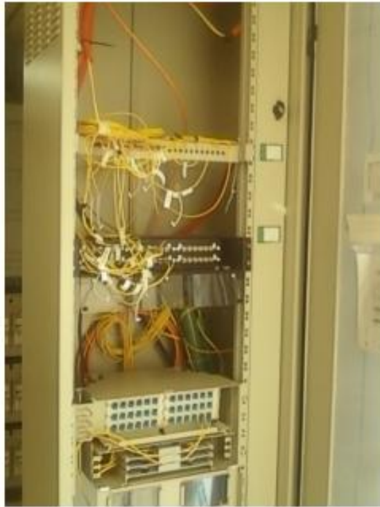
Figura 3.6 Distribuidor óptico ubicado en la sala Carrier.
