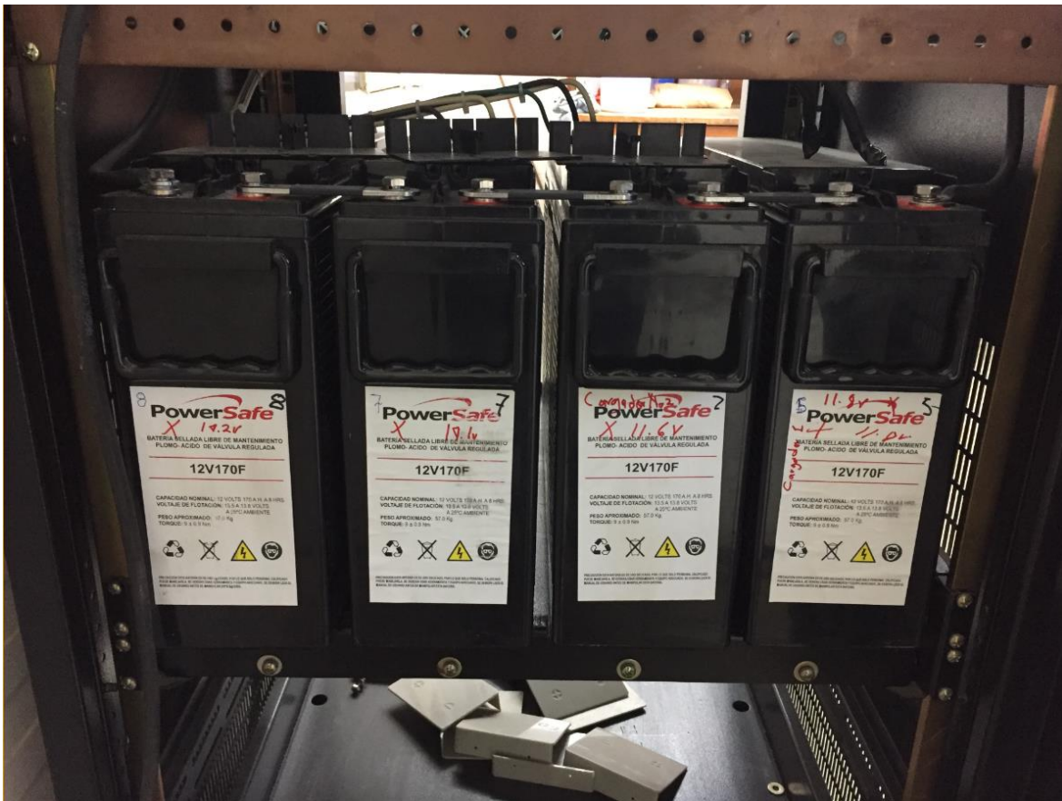
Ilustración 12. Banco de Baterías.
