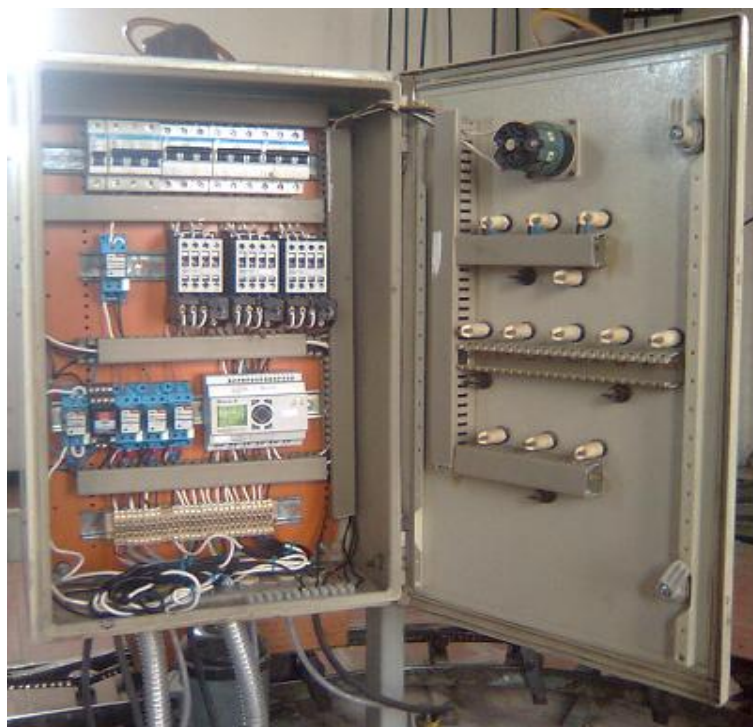
Fig. 3.3 Aspecto final del panel de control
