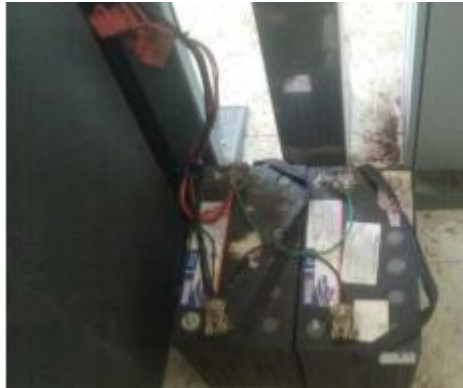
Imagen 3.23 Banco de baterías
