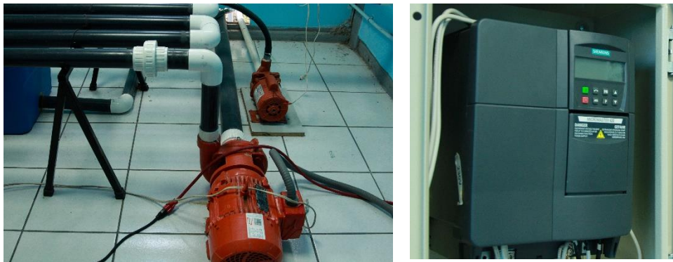
Figura 17 bomba de 5HP y variador de frecuencia
