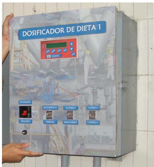
Figura 4.3 Tablero de Control instalado en el área de mezclas.
