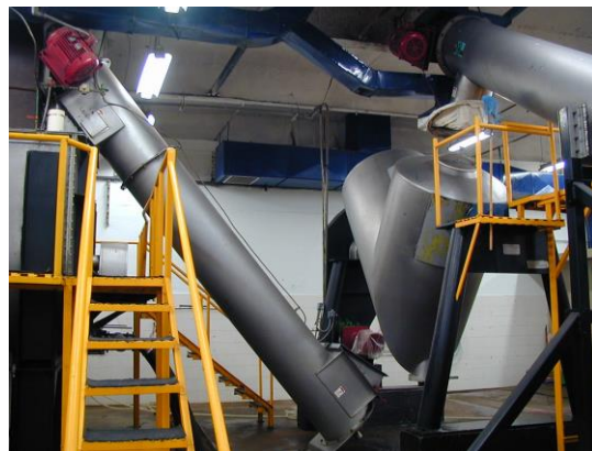
e) Tubería donde pasa los polvos mezclados
