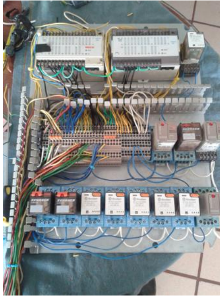
Figura 4.31: Vista final del tablero de pruebas
