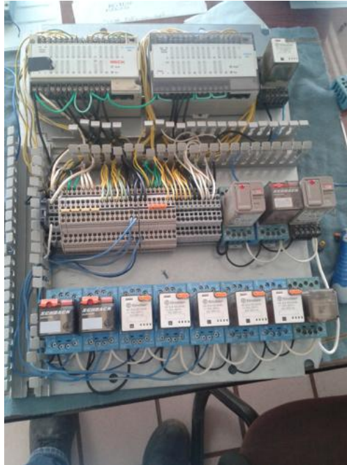
Figura 4.29: Tablero de pruebas con relevadores
