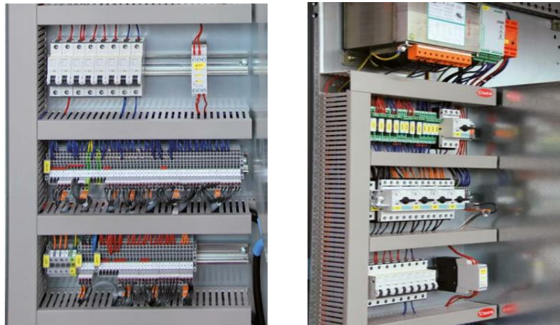
Figura 5 Uso de canaleta ranurada en tableros eléctricos
