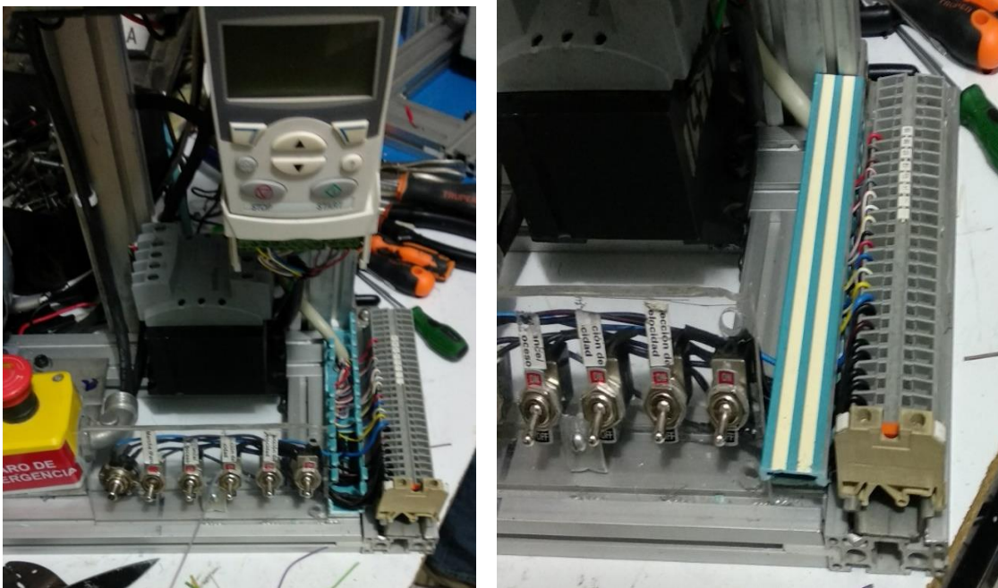
Fig. 3.21 Cableado hacia las clemas de conexión
