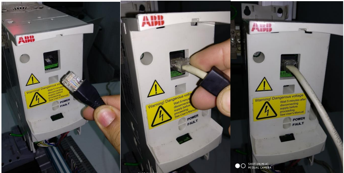
Fig. 3.61 Variador ABB sin la pantalla LCD y conexionado del cable OPCA-02
