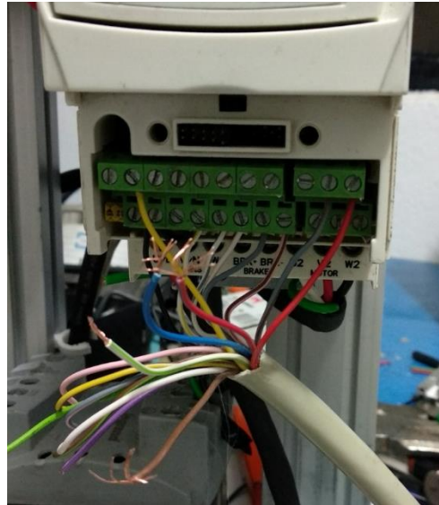
Fig. 3.20 Cableado del área de control variador de frecuencia
