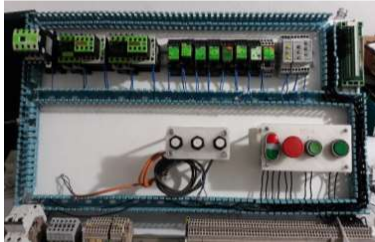
Fig. 3.31 Cableado de componentes
