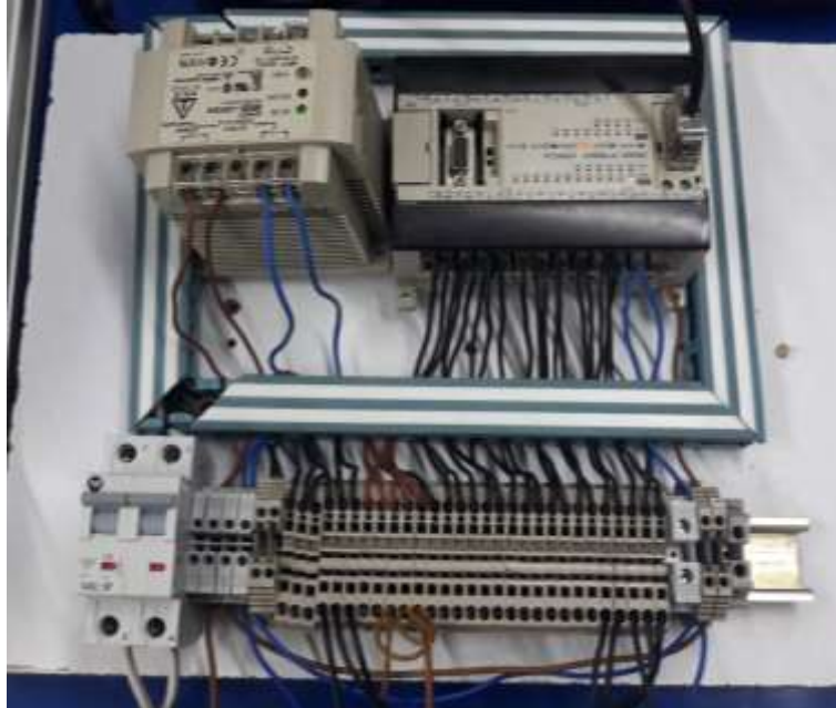
Fig. 3.35 Tablero de PLC omron CPM2A
