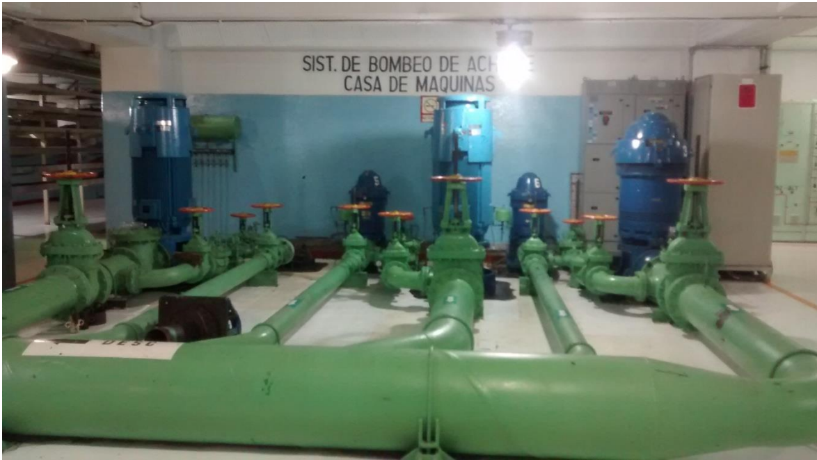
Figura 4.20. Sistema de bombeo de achique de casa de máquinas.
