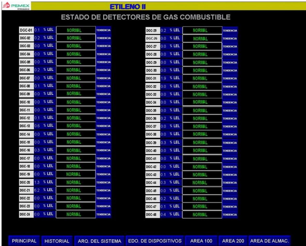
Figura 30.4.- Estado de Detectores de Gas Combustible.
